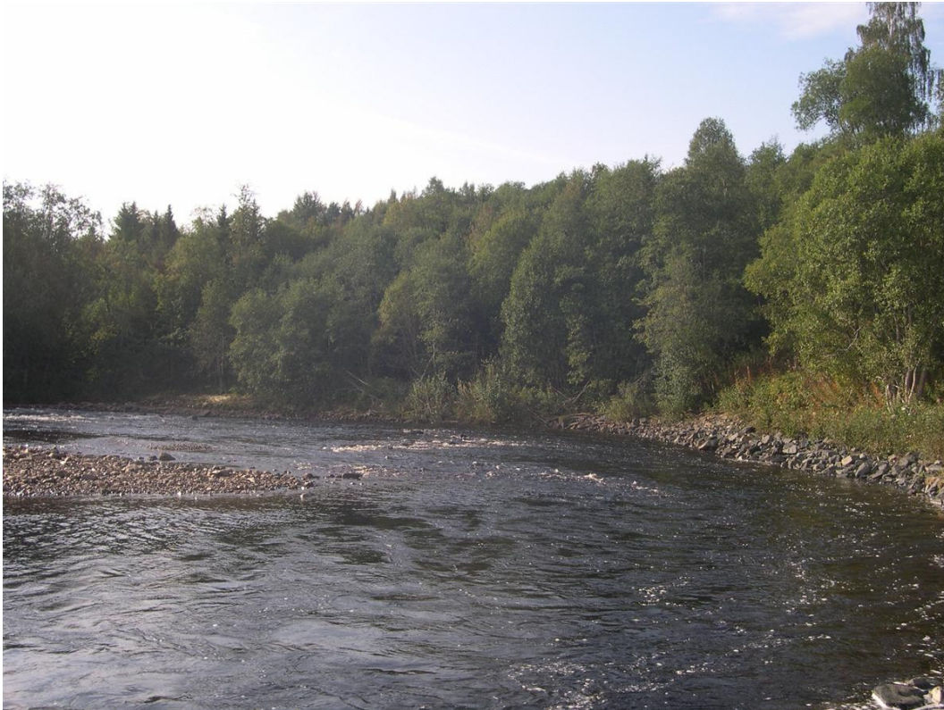
Bilde 12: Sikring i elvesiden. Det har tidligere foregått erosjon i siden.
