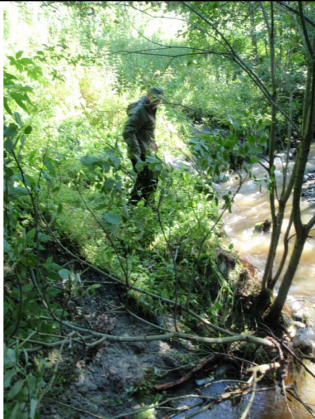
Bilde L 1 Erosjon i yttersvinger, sørside
