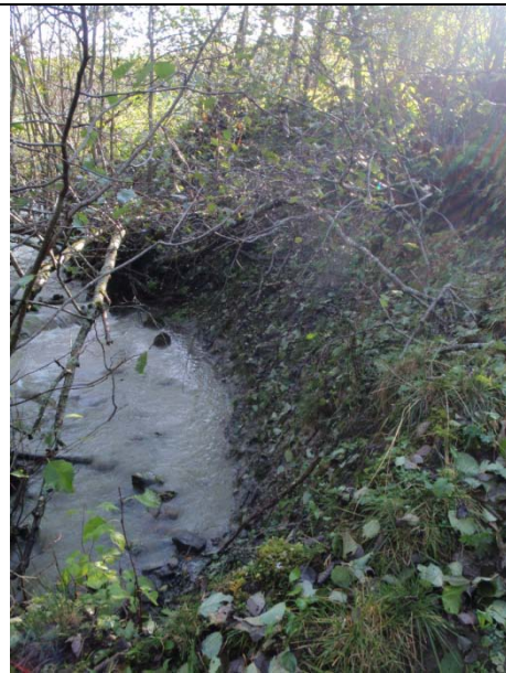
Bilde H 8 Erosjon i yttersving (sone Rødde) etter bekk kommer ut av rør
