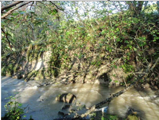
Bilde H 9 Erosjon i yttersving (sone Litj-Ler) etter bekk kommer ut av rør
