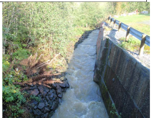
Bilde S 4 Erosjonssikring på begge sider de siste 50 m før broa
