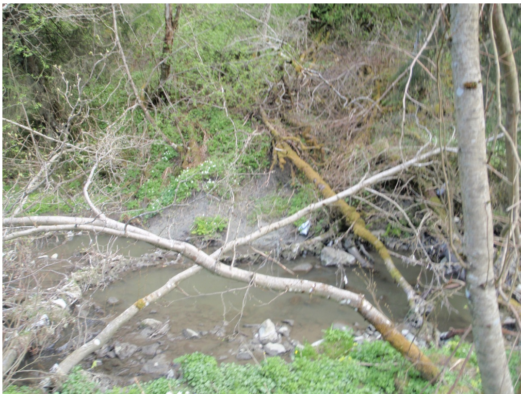
Figur 3 Bilde nr. 41. Her ble det registrert "litt" erosjon i yttersving (like nedstrøms utløp av kulvert, sone «Rosten nord»)
