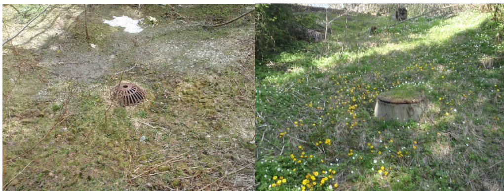
Figur 14 Ravine ved avgrensning i sør. Bilde 23, til venstre, og 24, til høyre, viser kummer hhv. ovenfor og nedenfor jernbanen. Bekken er her lagt i rør.
