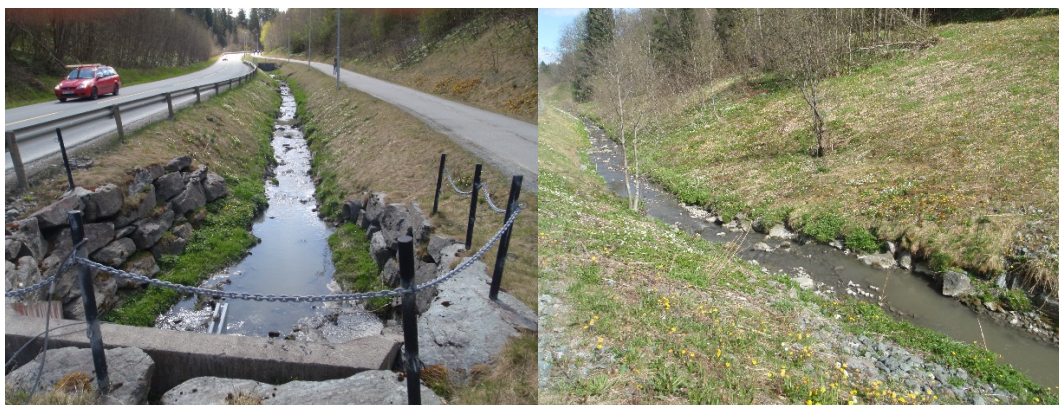
Figur 1 Eksisterende erosjonssikring lang Heimdalsbekken. Bilde 26 til venstre og bilde 27 til høyre. Bilde 26 er tatt oppover, mens bilde 27 er tatt nedover langs bekkeløpet.
