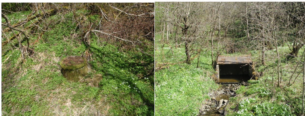
Figur 10 Bilde nr. 33 og 40. Kum i nedre del av den sentrale ravinen på Rosten – sonen (venstre). Utløp av overvannsledning fra Rosten i Bjørndalen, ca. 80 meter nedenfor utløpet av den sentrale ravinen (høyre).
