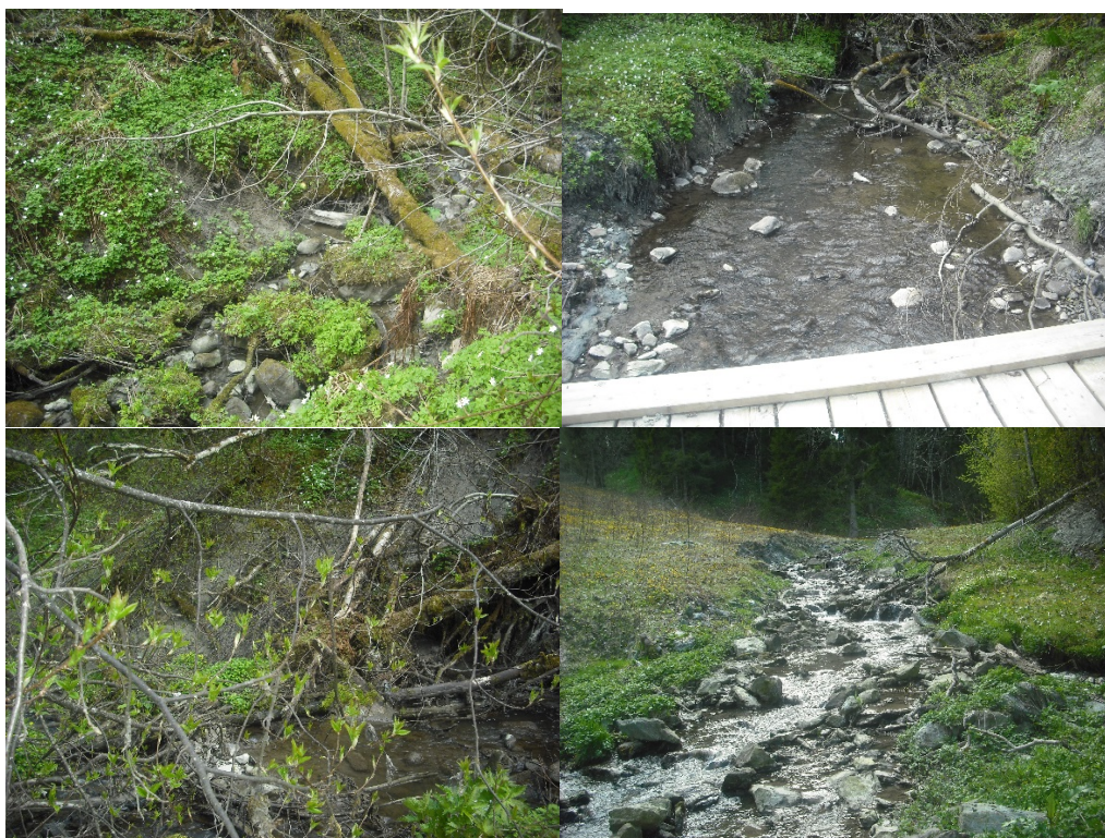
Figur 13 Nordre ravine, oppstrøms jernbanen. Her er det på enkelte steder registrert "litt" erosjon.
