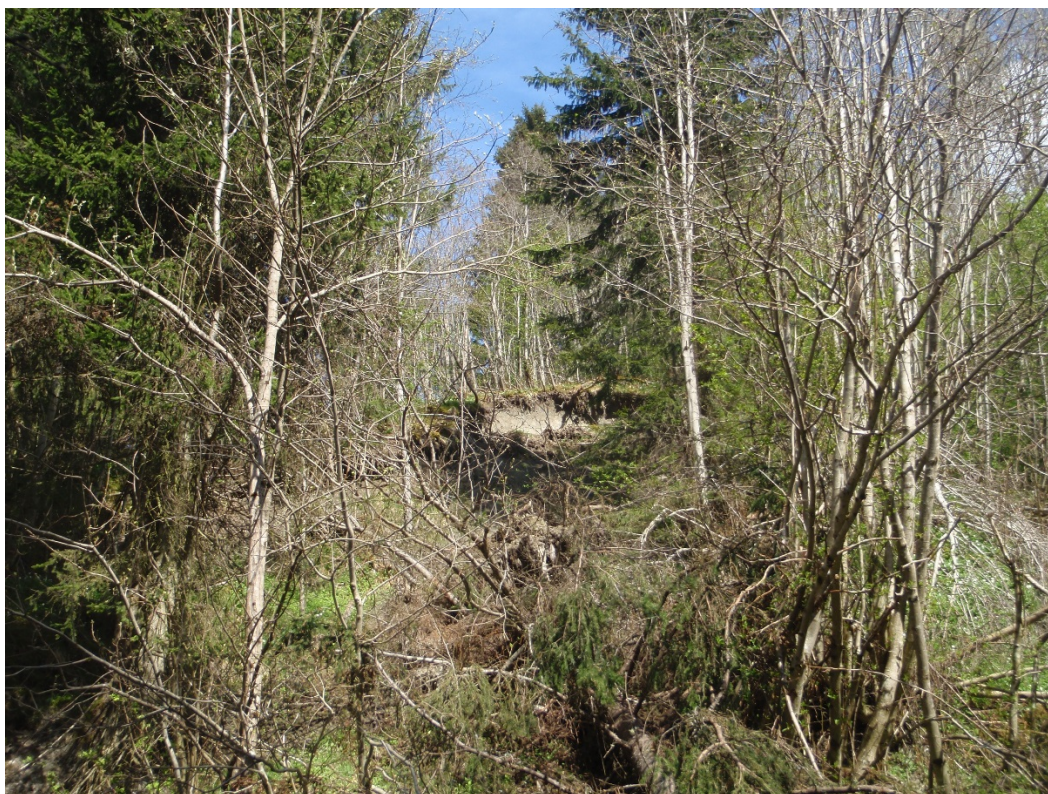
Figur 8 Bilde nr. 32. Bildet viser en overflatautglidning i den bratte skråningen på venstre side i søndre ravine (like ovenfor utløpet).
