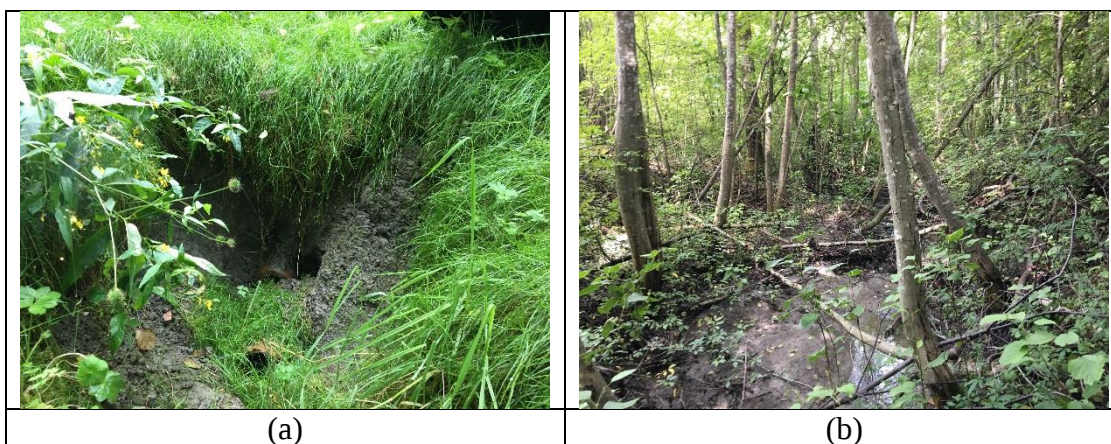
Figur 19 Fotografier fra befarings, Sted 19: (a) vann fra drenerør eroderer i leire, fersk utglidning, (b) mange nedfalte trær i bekken.
