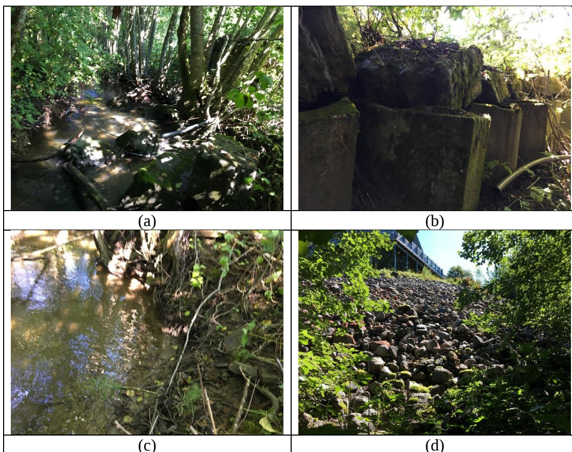
Figur 9 Fotografier fra befaring, Sted 9: (a) store steinblokker i bekken (erosjonssikring?), (b) kum og stein støtter opp skråningen nedenfor Korvaldveien 120, (c) litt erosjon i siltig leire, (d) steinplastring nedenfor Korvaldveien 120.
