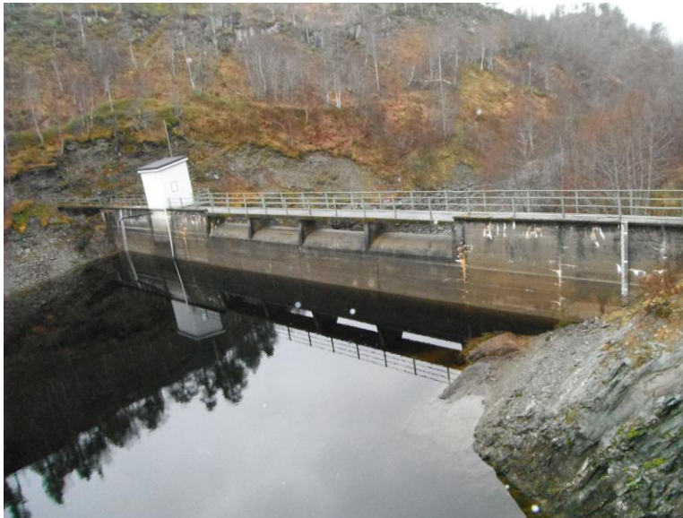
Foto 10.6, Erik Husby: Dam Geitøyvatn ved vannstand på kote 333,58 moh. tatt 6.11.2013
