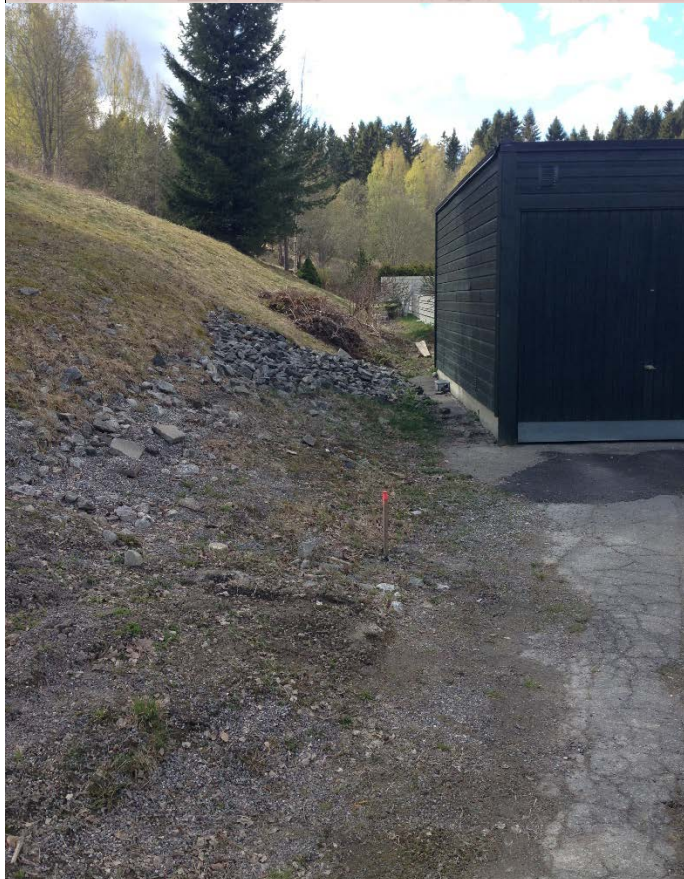
Figur 6 Øverst: Garasje og steinplastring i skråningsfoten (rød ring). Nederst: Steinplastring ved garasje inntil skråningsfoten. Nedre del av skråningen har noe større helning enn skråningen lenger opp, muligens pga. menneskelige inngrep.
