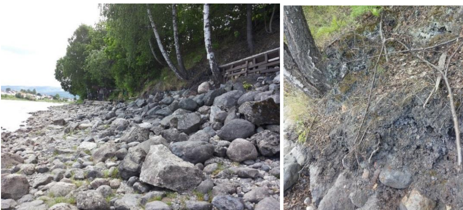
Figur 3: Eksisterende erosjonsbeskyttelse langs Drammenselva, samt et eksempel på pågående, avgrenset erosjon.
