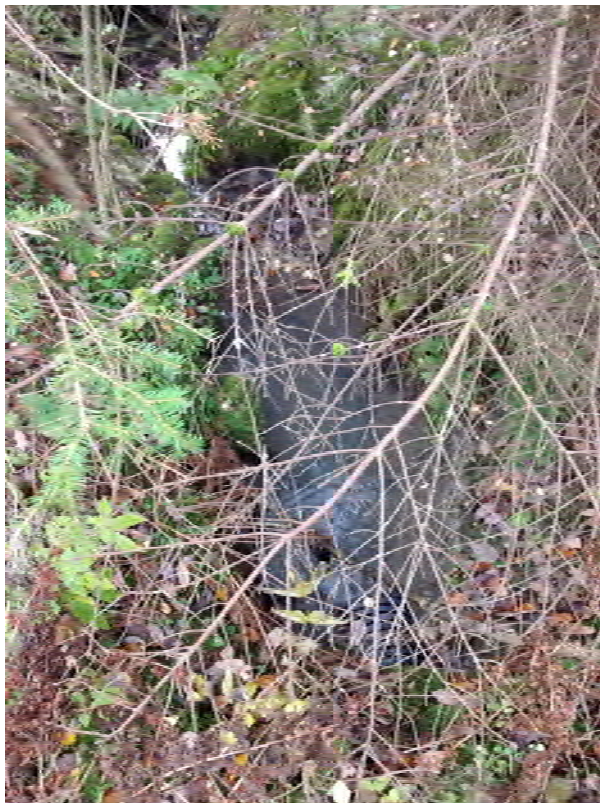
Figur A2: Stikkrenne under traktorvei i D1. Ved store mengder vann kan erosjon utvikle seg
