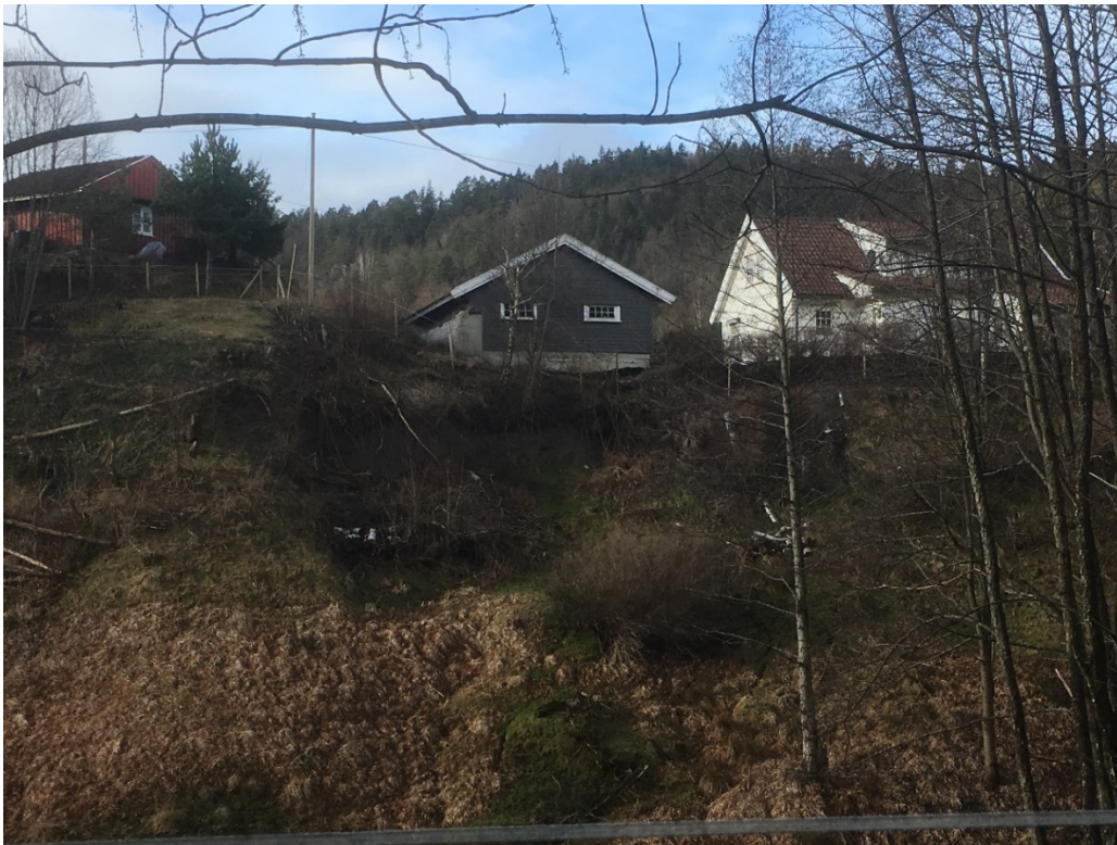
Figur 7 Bilde av utglidning under garasje i Setesdalsveien 352.
