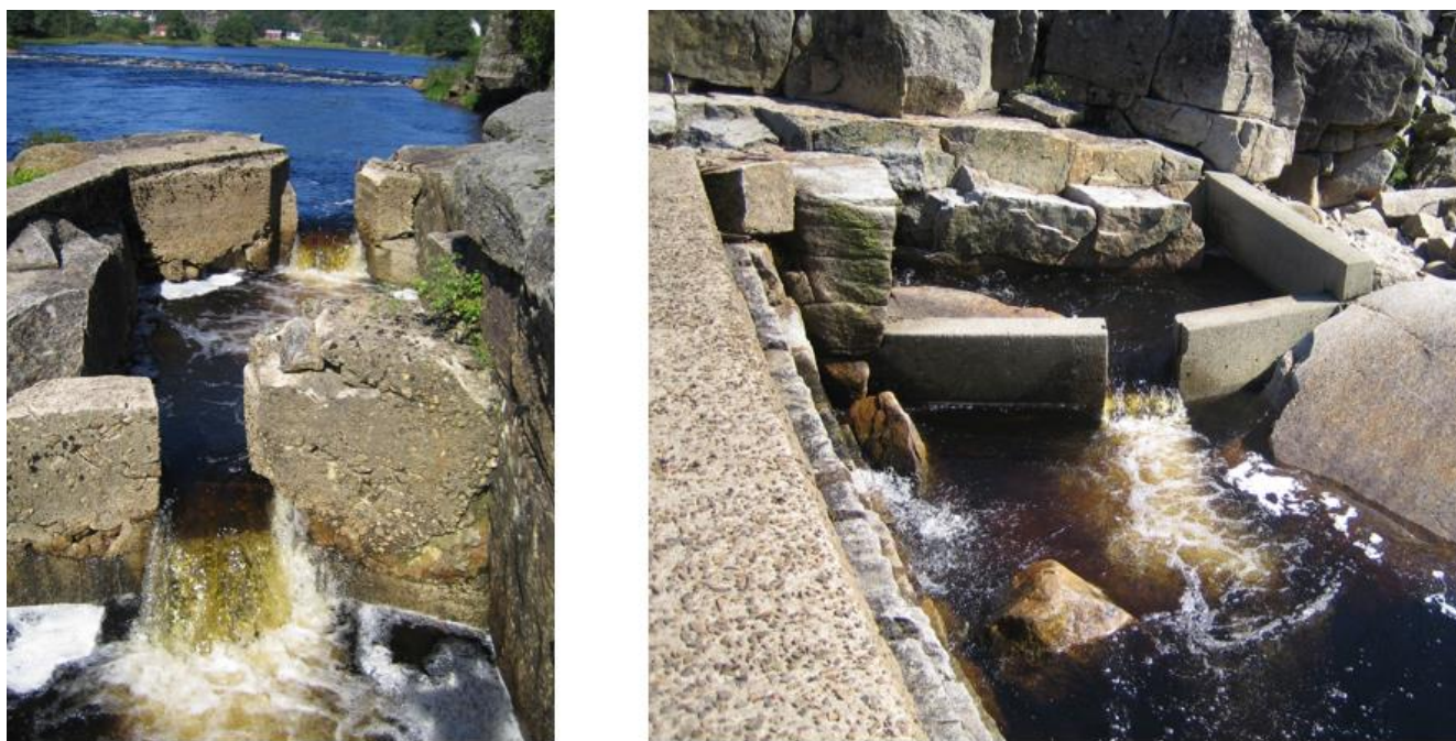
Figur 11: Øvre og nedre del av laksetrapp ved inntak.
