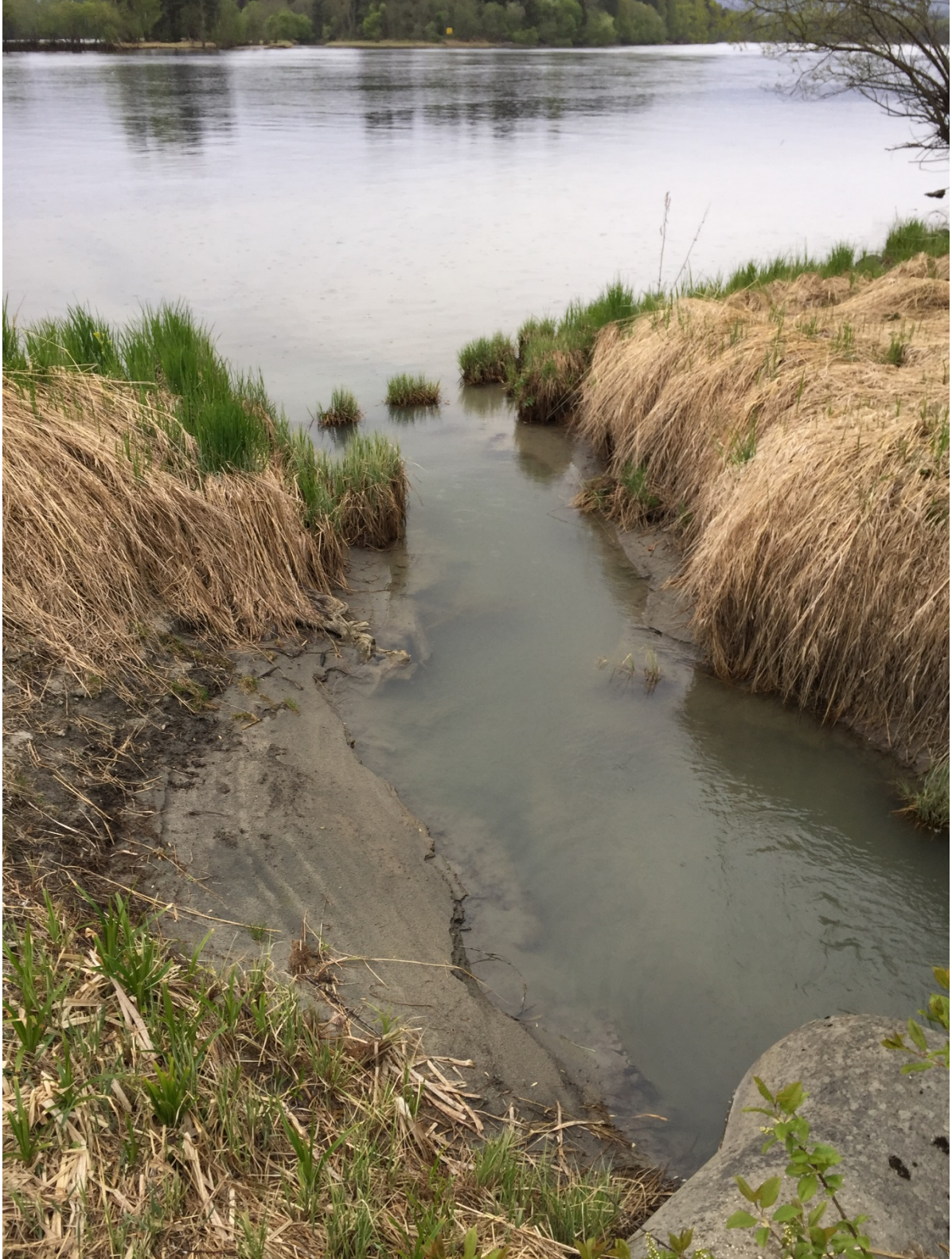
Figur 3-4 Erosjon av bekk ut i Drammenselven fra utløp av drensledning.
