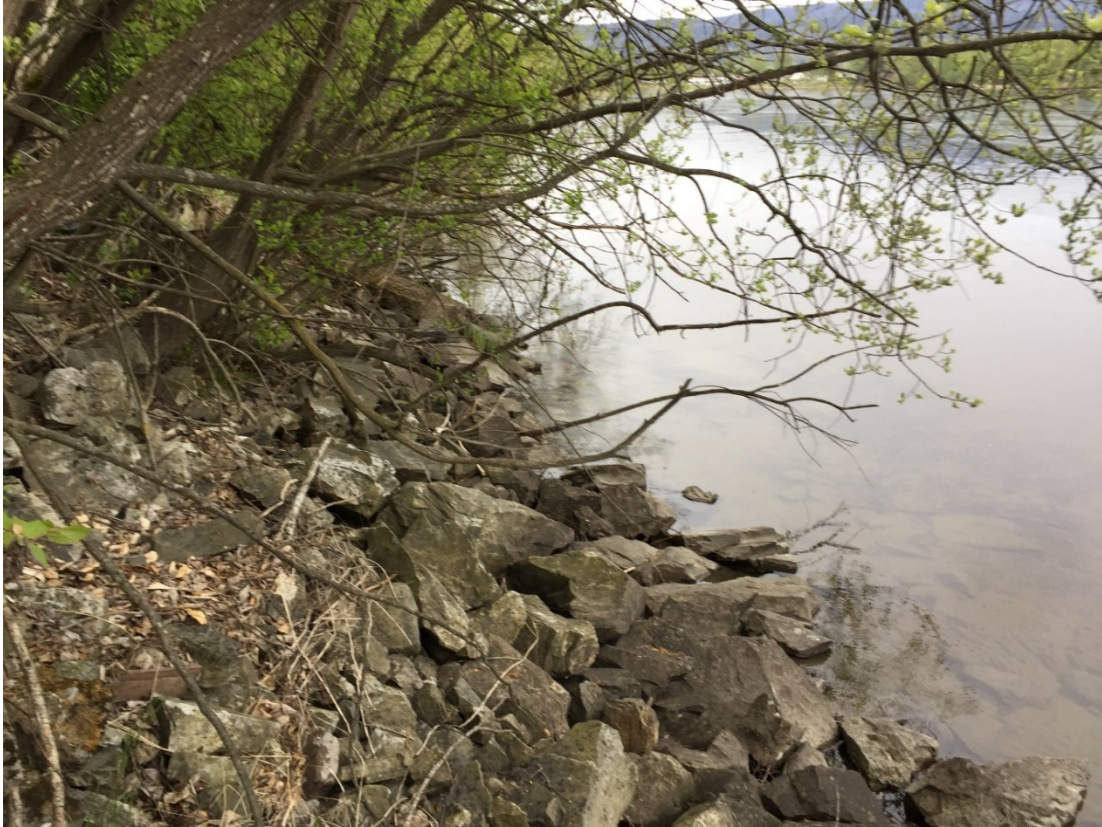
Figur 3-5 Eksempel på materiale som virker som erosjonssikring i strandsonen.
