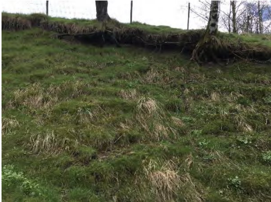
Figur 46 Fotografier fra befaring i området ved Klepp: (ø.v.) bekk sørvest-litt erosjon, (ø.h.) bekk sørøst-litt erosjon, (m.v.) fylling i sideravine med søppel og gravemasse, (m.h.) erosjon i leire pga. drenerør, (n.v.) overflateskred/sig nord i sonen.
