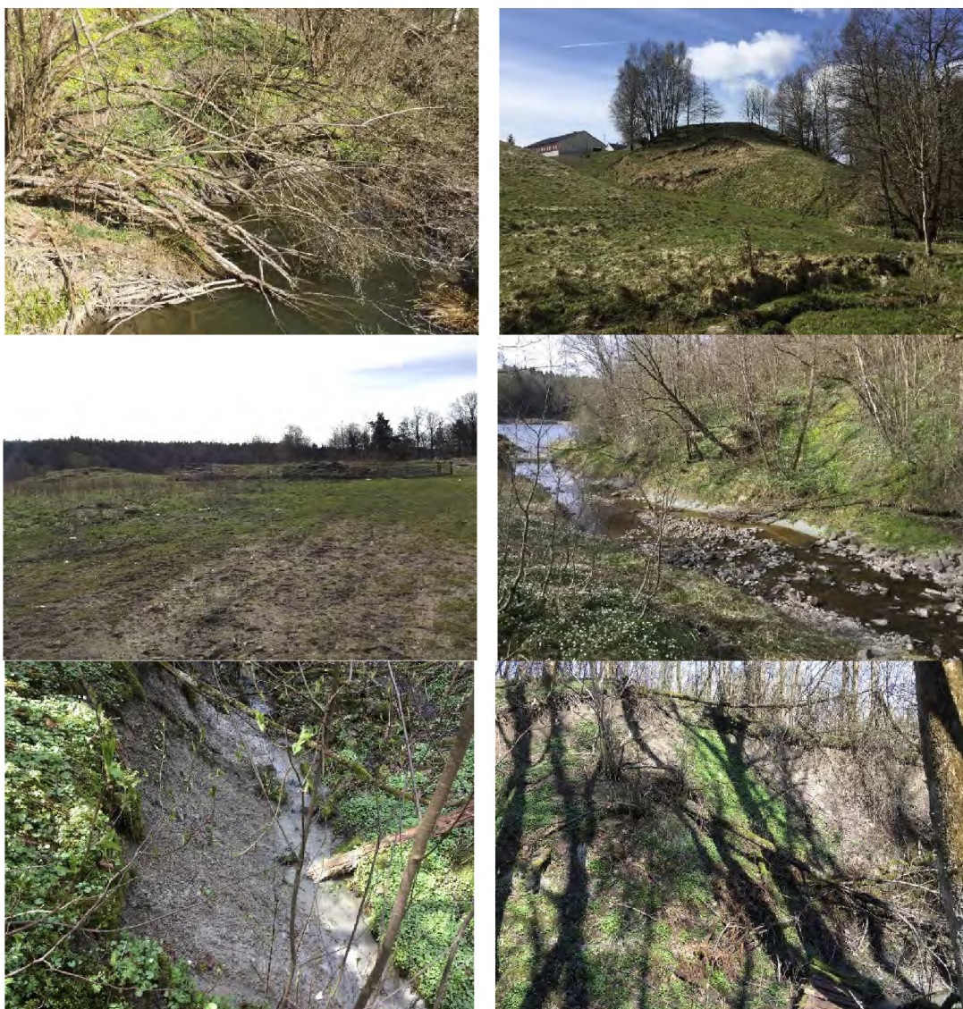
Figur 50 Fotografier fra befarings i området ved Øyestad: (ø.v.) litt erosjon i leire, (ø.h.) skredgrop, (m.v.) berg i dagen sør for Øyestad gård, (m.h.) litt erosjon i leire skråning ved Rykenveien 809, (n.v.) aktiv erosjon i bekken i nord, (n.h.) overflateskred nord i sonen.
