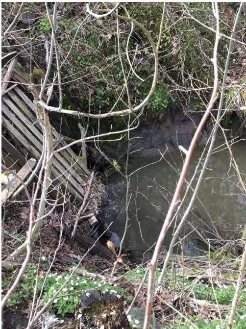
Figur 62 Fotografier fra befaring i området ved Tingstveitveien Nedenes: (ø.v.) Erosjon i leire i svingen helt sør i området. Vann noe blakket. (ø.h.) Berg i dagen i bekken øst for svingen (n.v.) leire i dagen og mulighet for oppstuvning av vann før kulvertlukking.
