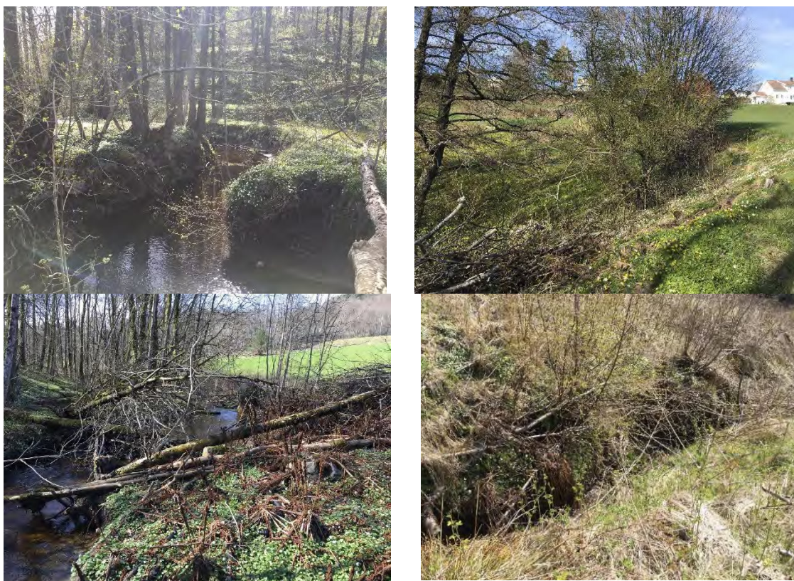
Figur 24 Fotografier fra befaring i området ved Spedalen: (ø.v.) litt erosjon i bekken, plastring i yttersving i sør, (ø.h.) gammel skredgrop på jordet, (n.v.) lite erosjon i bekken i nordvest, dreneringsgrøft ned langs jordet, lite erosjon.
