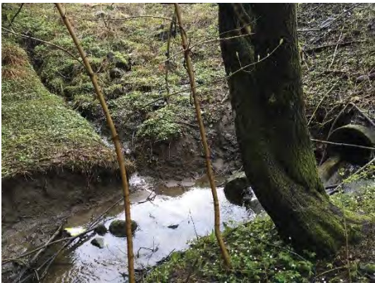
Figur 40 Fotografier fra befaring i området ved Gamle Prestevei: (ø.v.) og (ø.h.) bekk vest for kvikkleiresone, delvis stein(plastret?), (m.v.) overflateskred, (m.h.) noe erosjon ved kulverten under vei (bekk mot øst), (n.v.) lite erosjon i bekken i nordøst.
