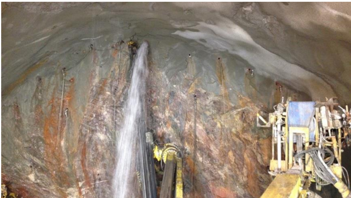
Lekkasjer i Mæletunnelen i Telemark
