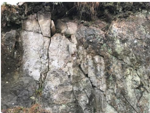
Råtefjell / sprekker i fjellet
