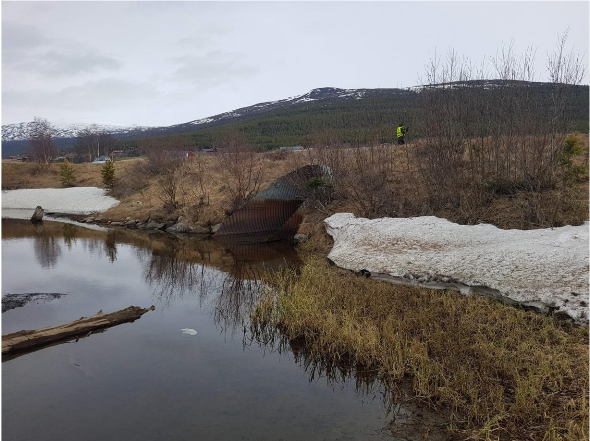
Figur 22: Rør fra kanal 4 ut i Lågen, innløp ved S-1200 (Bilde: Multiconsult)
