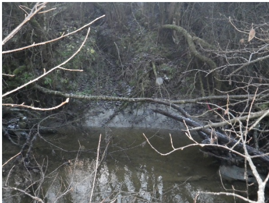
Figur A32. Erosjon og overflateutglidning langs bekkesidene nedstrøms jernbanekulverten på Kvamsleret,
