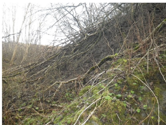
Figur A22. Utglidning ovenfor vegkulverten på Kvammen.
