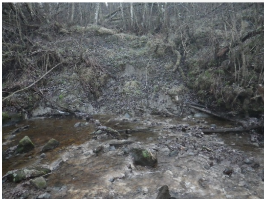
Figur A11. Utglidning mot Stokkaunet nedstrøms jernbanekulverten.
