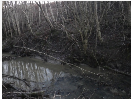
Figur A35. Erosjon langs bekkesidene nedstrøms jernbanekulverten på Kvamsleret.
