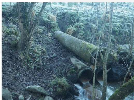
Figur A5. Høralsdalsbekken kommer ut fra røret.
