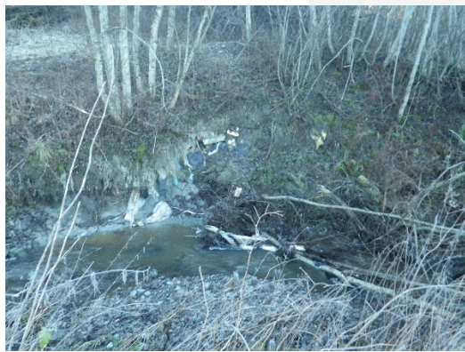
Figur A18. Utglidning mot Stokkaunet nedstrøms vegbrua.
