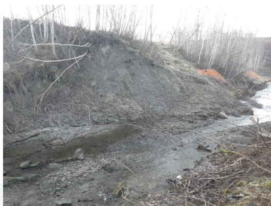
Figur A29. Aktiv erosjon nedstrøms vegkulverten på Kvammen.
