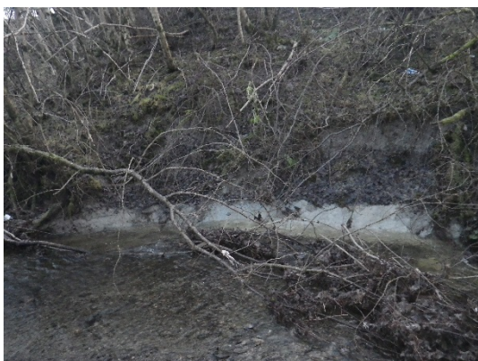
Figur A30. Erosjon langs bekkesidene nedstrøms jernbanekulverten på Kvamsleret.
