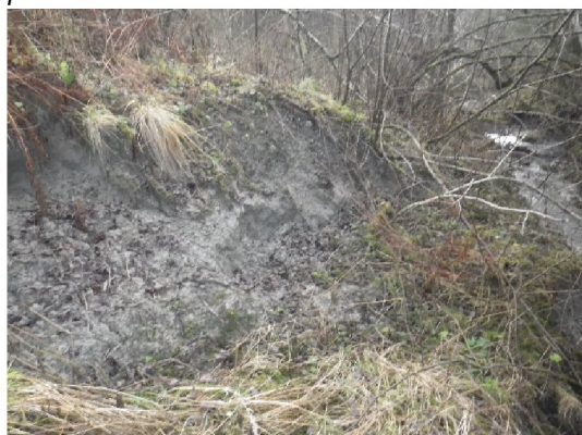
Figur A26. Aktiv erosjon ovenfor vegkulverten på Kvammen.
