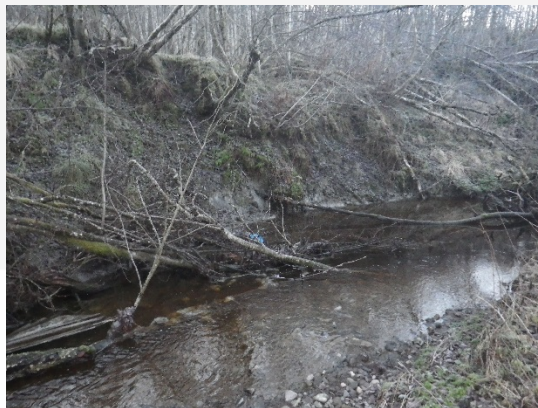
Figur A12. Noe erosjon i bekkesida mot Stokkaunet nedstrøms jernbanekulverten.
