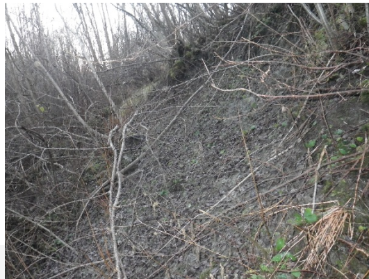
Figur A33. Overflateutglidning nedstrøms jernbanekulverten på Kvamsleret.
