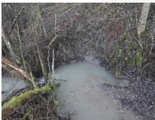
Figur A4. Noe erosjon mot Rødde.
