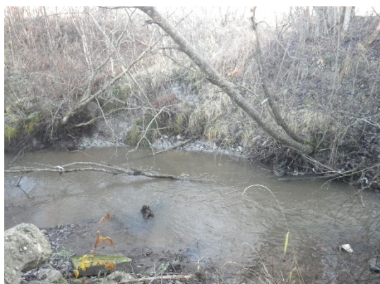
Figur A19. Utglidning mot Åsgarden nedstrøms vegbrua.
