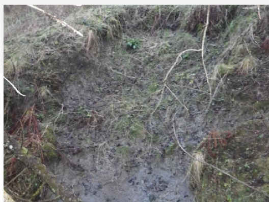
Figur A25. Utglidning ovenfor vegkulverten på Kvammen.
