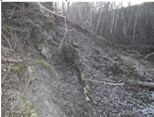
Figur A36. Aktiv erosjon nedstrøms jernbanekulverten på Kvamsleret
