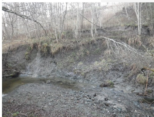
Figur A27. Aktiv erosjon ovenfor vegkulverten på Kvammen.
