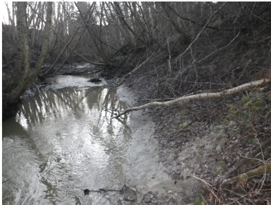
Figur A34. Overflateutglidning nedstrøms jernbanekulverten på Kvamsleret.
