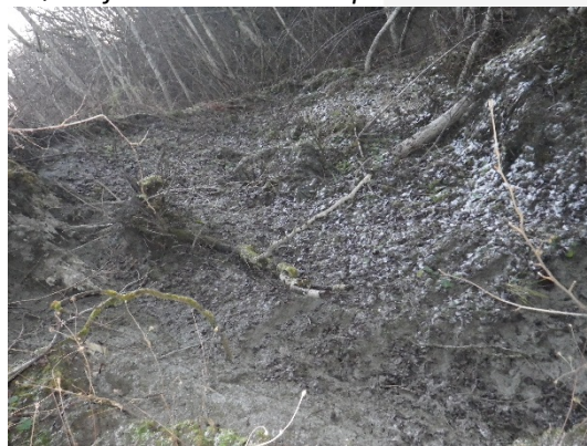
Figur A37. Aktiv erosjon nedstrøms jernbanekulverten på Kvamsleret
