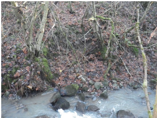
Figur A8. Noe erosjon i bekkesida etter jernbanefyllingskulvert.
