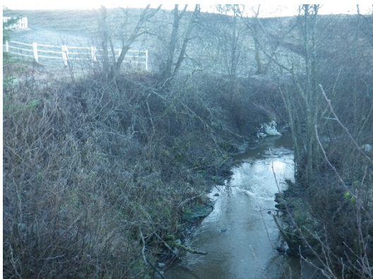
Figur A17. Erosjon ved vegbrua.
