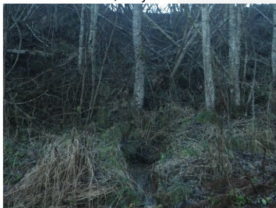
Figur A14. Utglidning mot Rødde oppstrøms kryssing mellom Hørsdalsbekken og Stokkbekken.
