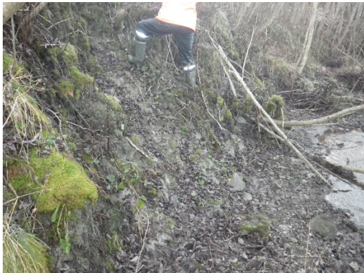
Figur A15. Noe erosjon på bekkesida mot Stokkaunet oppstrøms kryssing mellom Hørsdalsbekken og Stokkbekken.
