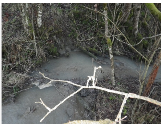
Figur A2. Noe erosjon mellom Røddeshåggån og Rødde.
