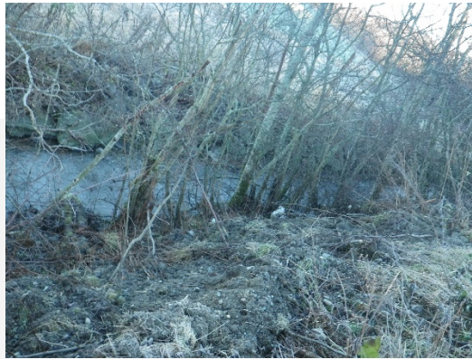
Figur A16. Utglidning mot Rødde oppstrøms kryssing mellom Hørsdalsbekken og Stokkbekken.
