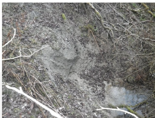
Figur A23. Erosjon i leira ovenfor vegkulverten på Kvammen.
