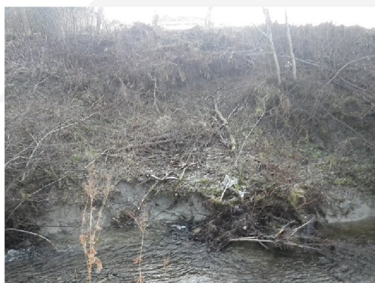
Figur A24. Utglidning ovenfor vegkulverten på Kvammen.
