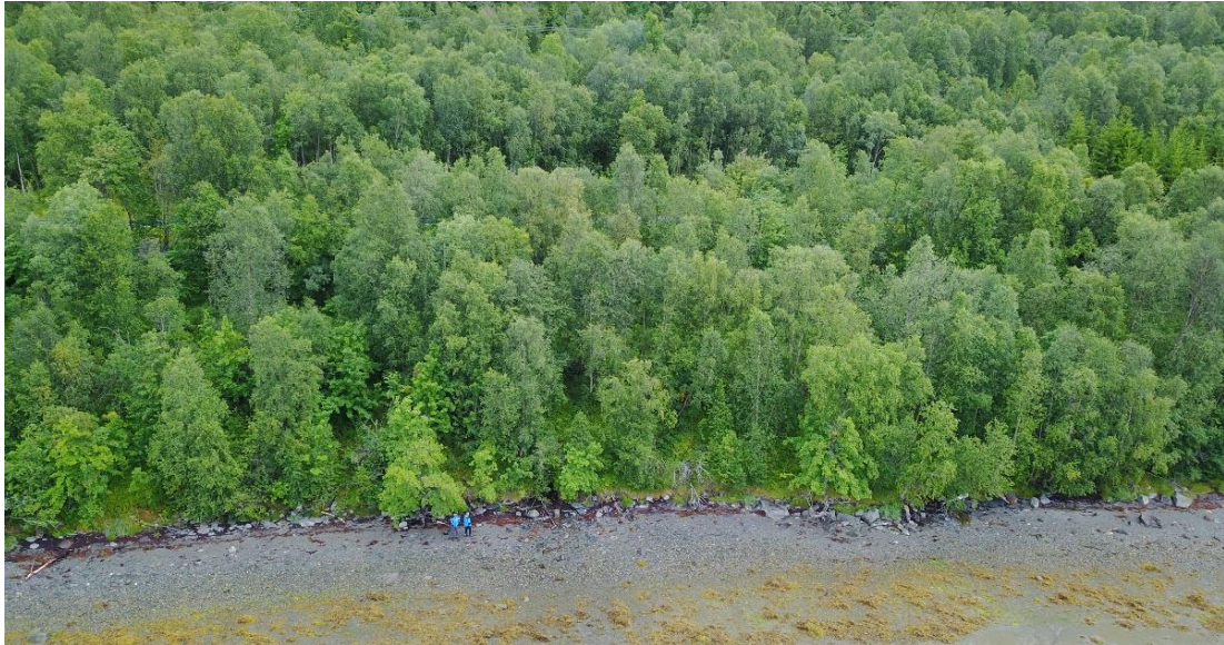
Figur 12 Oversiktsbilde over interesseområdet, tatt med drone. Erosjonen er aktiv i strandsonen. E6 går på toppen av skråningen, ca. midt i trærne på bildet.
