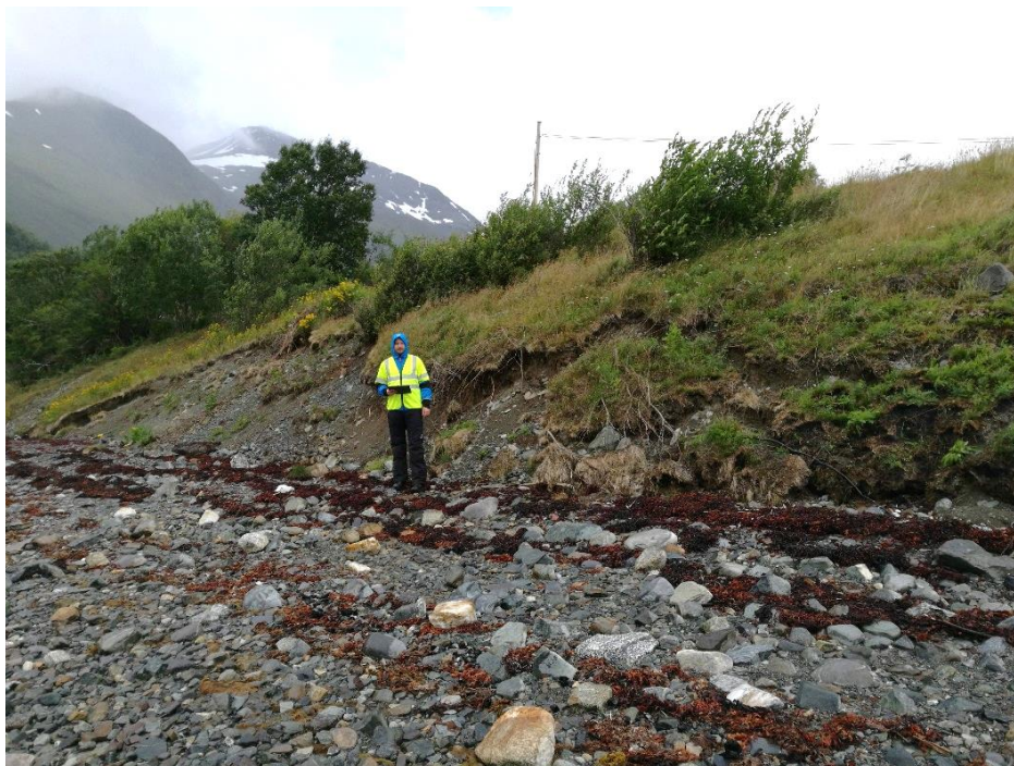
Figur 108 Skråning i strandsonen med aktiv erosjon ved skråningsfoten.
