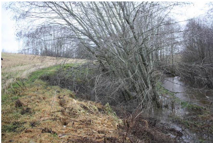
Større utglidning inn mot hovedbekken. Samme utglidning som vist på bilde nr 14.
