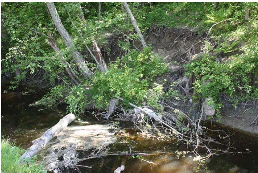
Utglidning på elvekant mot øst. Lengde ca 6 m Bekkekant 2-5 m
