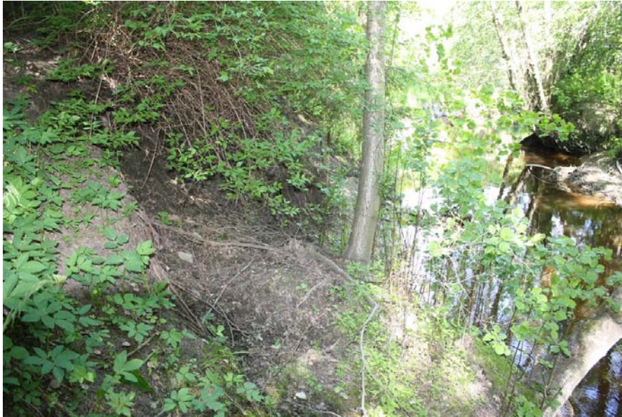
Utglidning nedstrøms av forbygning ved Gartnerløkka. Høydeforskjell på bekkekanten er her 6-10 m.
