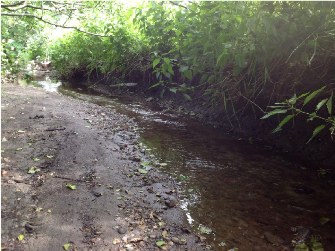
B 1- 99: Litt erosjon i bekken
