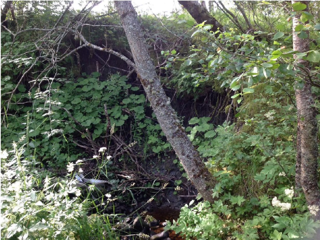
B 1- 71: Overflateglidning i yttersving av bekk pga. sideveiserosjon. Naturlig erosjonsbelyttelse i bunnen av bekkefare (Placemark 3 RMo).
