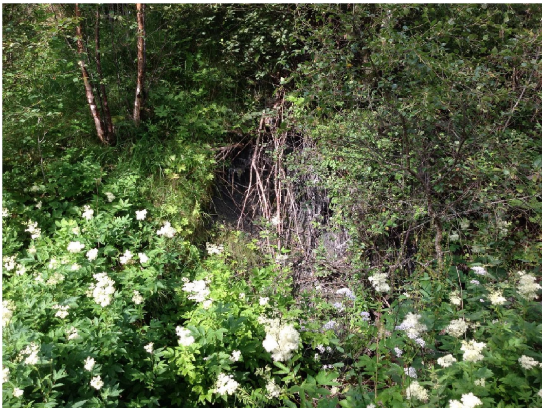
B 1- 73: Litt erosjon i yttersving (Placemark 5 RMo)
