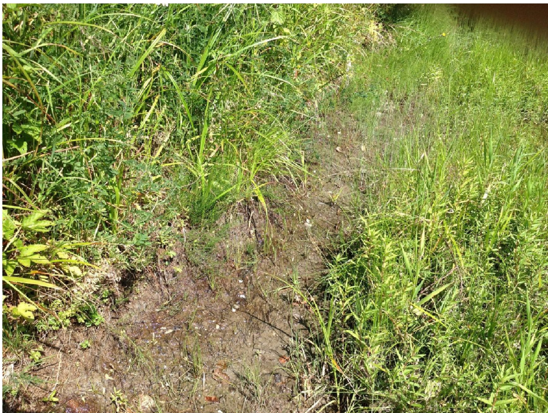
B 1- 57: Litt erosjon i kanten (Placemark 23 RMo)
