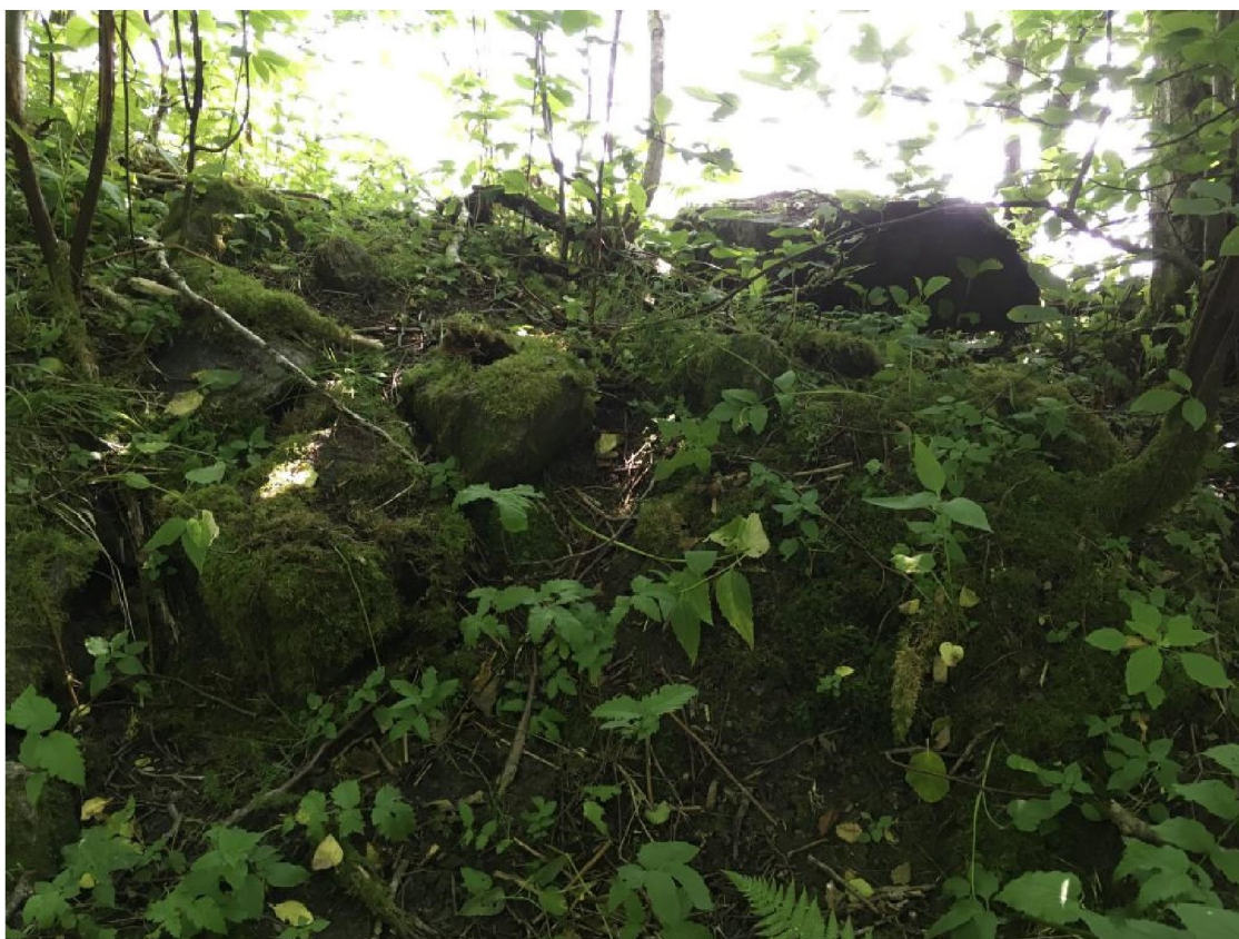
B 1- 46: Erosjonssikring mot elva. Bløtt på innsiden der det er et nedsunket område (står vann) (Placemark 4 RMo)
