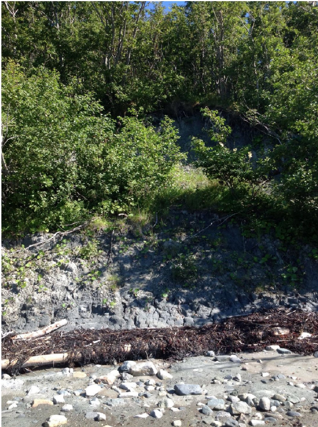
B 1- 35: Erosjon i foten av skråninger der sjøen står på (Placemark 8 RMo)
