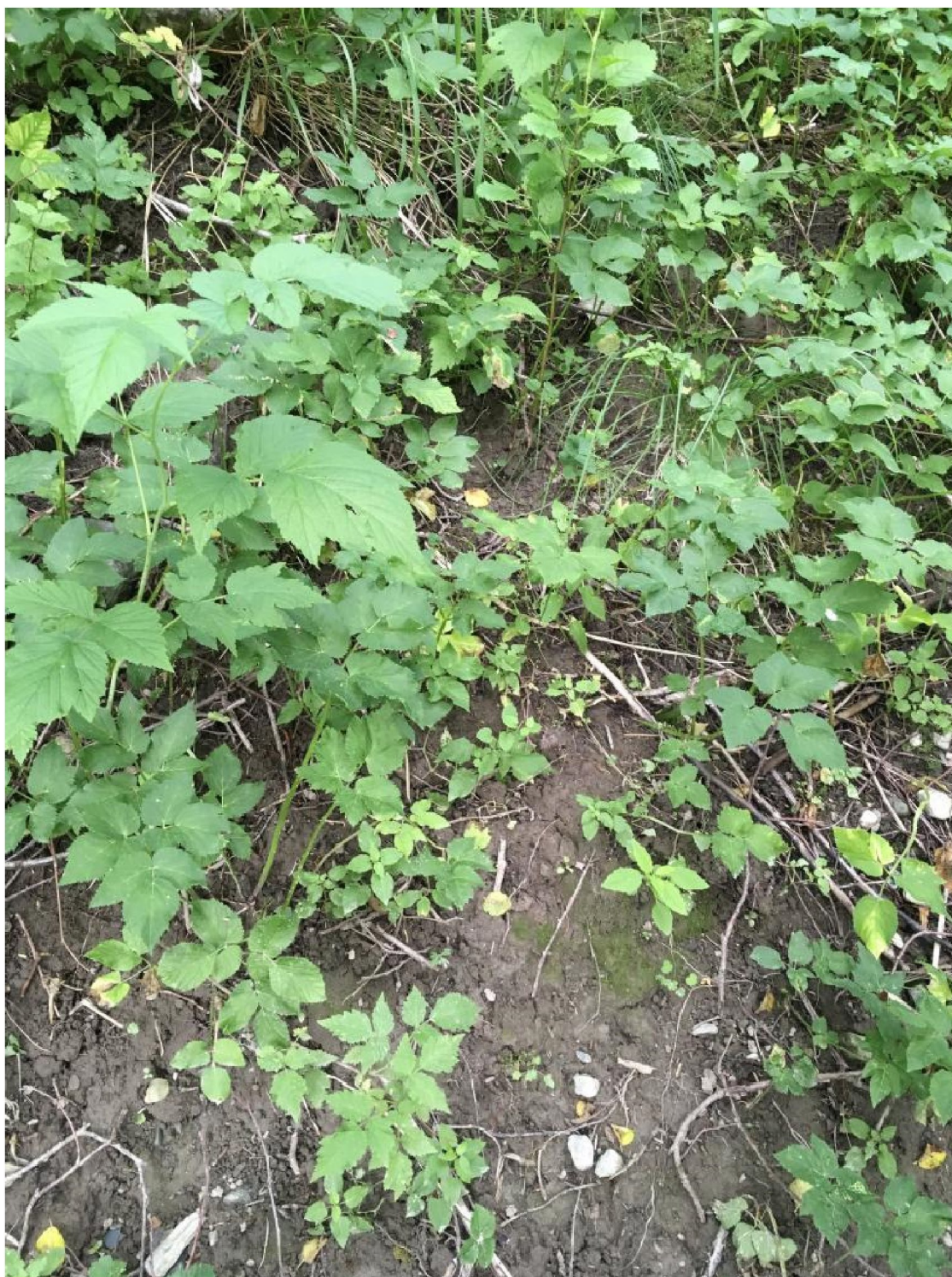
B 1- 51: Litt erosjon i foten av skåningen. Bratt terreng. Grunnen ser tørt ut (Placemark 16 RMo)
