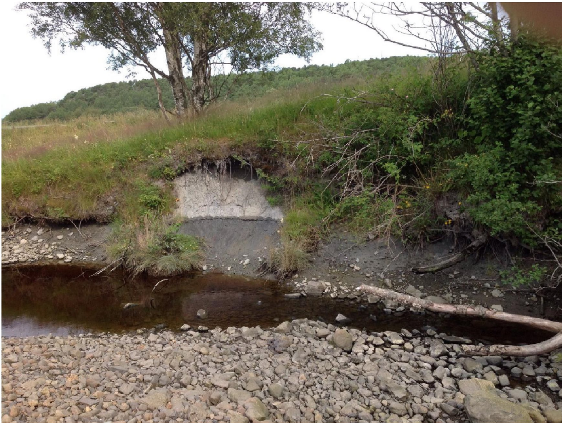
B 1- 86: Erosjon i yttersving (Placemark 21 RMo)
