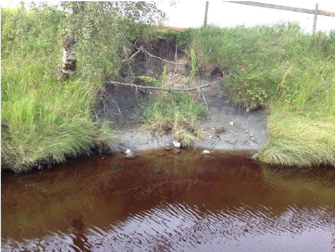
B 1- 87: Erosjon i yttersving (Placemark 22 RMo)
