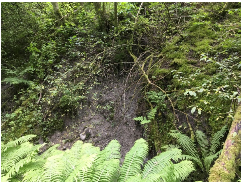
B 1 Liten utglidning/utvasking (litt erosjon).
