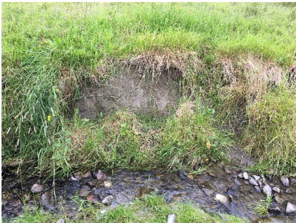
B 4 Utglidning. Skredkant ca. 1 m (noe erosjon).
