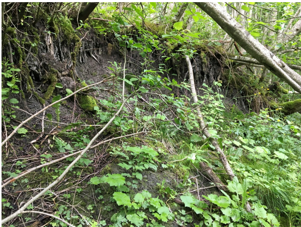
B 13 Liten utglidning (noe erosjon).
