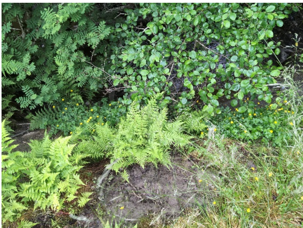
B 9 Mindre utglidning i yttersving (noe erosjon).
