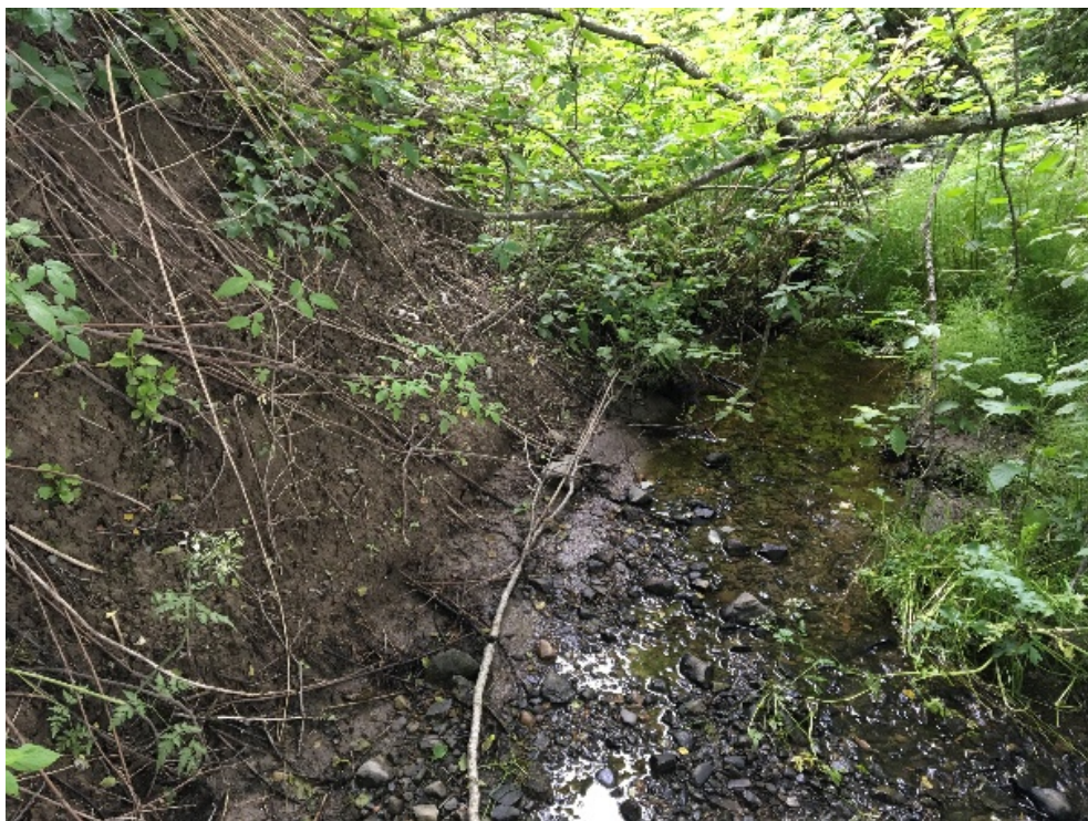
B 8 Overflateglidning (noe erosjon). Litt erosjon langs kanten.
