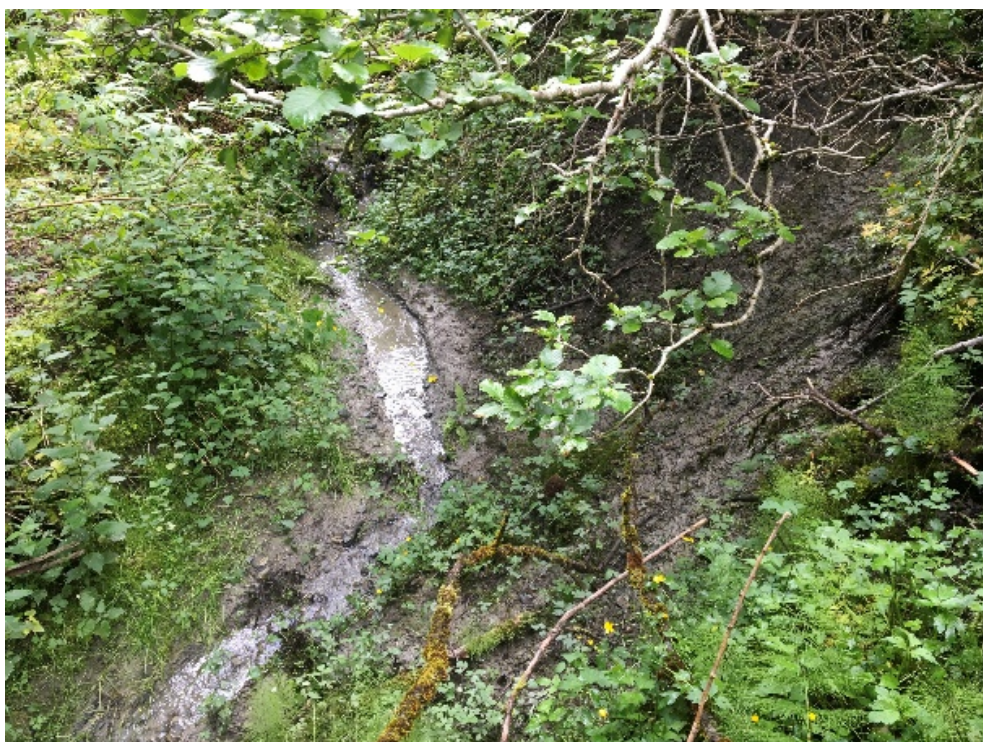
B 3 Noe erosjon. Bekken eroderer direkte på leire.
