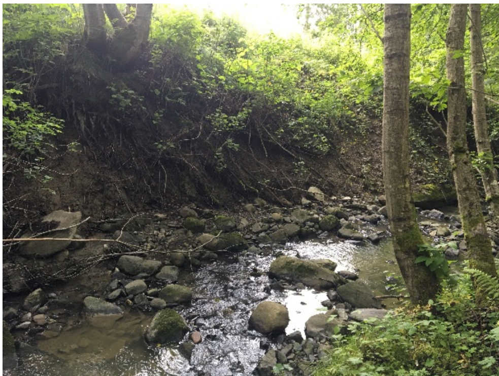
B 14 Overflateglidninger (noe erosjon).
