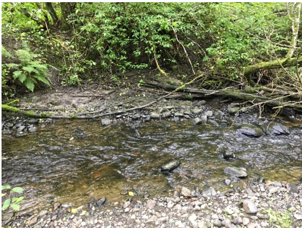
B 8 Mye stein. Erosjon i ytterkant (litt erosjon).
