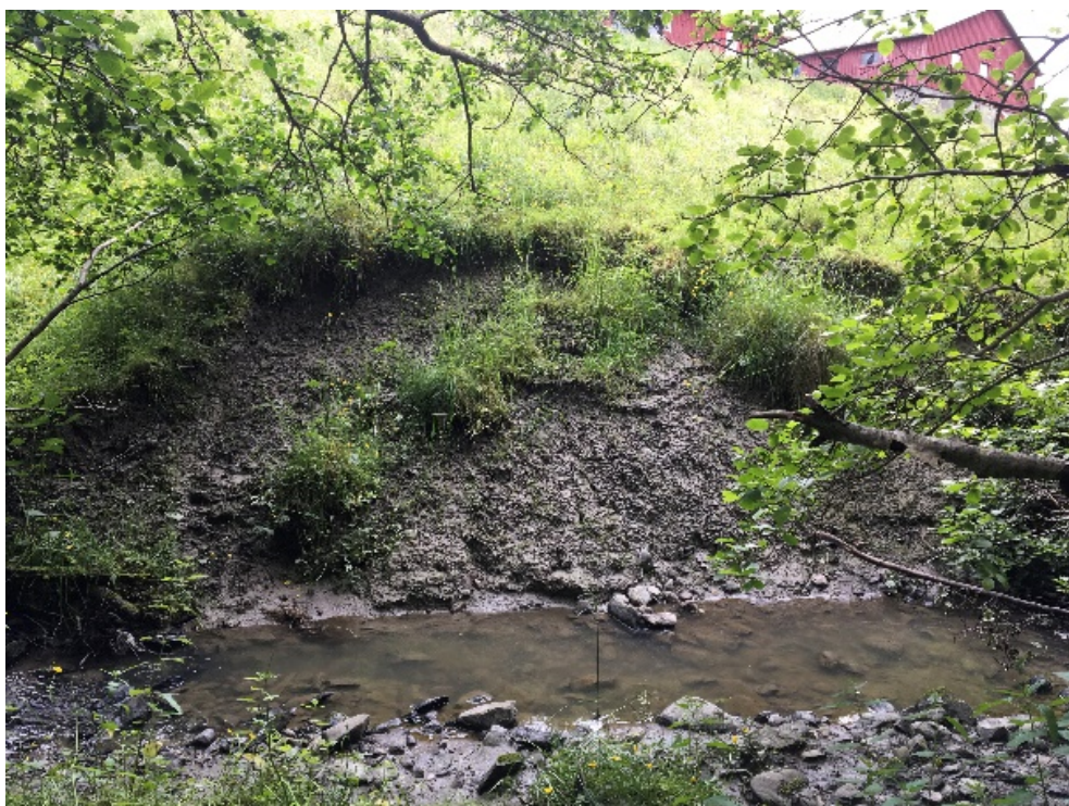
B 11 Overflateglidning (noe erosjon).
