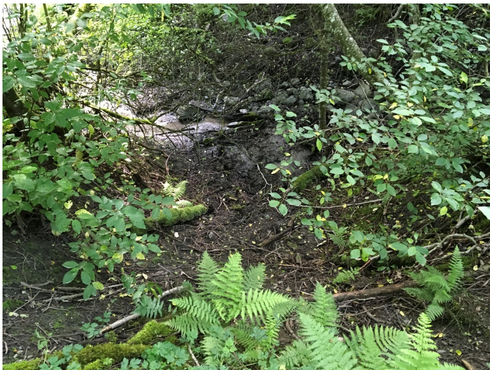
B 16 Bratte sider med overflatesig (litt erosjon).
