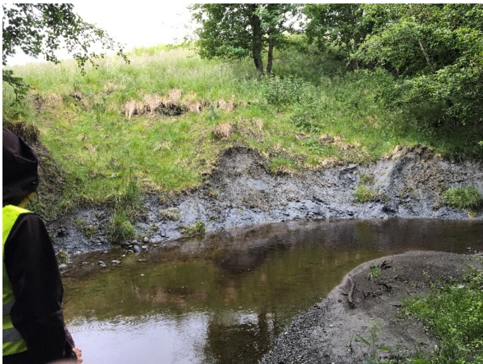
B 6 Graving i yttersving (litt erosjon).
