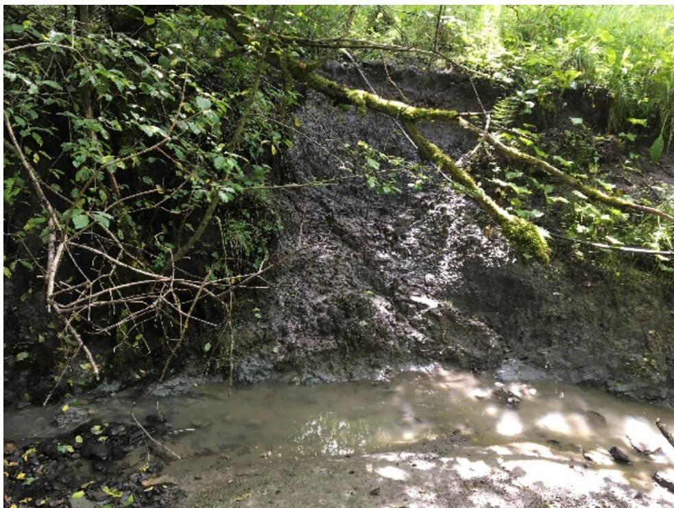
B 12 Utglidning, sprekker bak skredkanten. Bekken graver i leire (aktiv erosjon).
