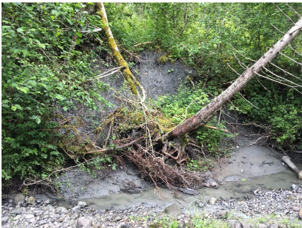
B 7 Utglidning (noe erosjon).
