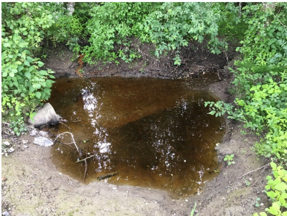
B 9 Erosjonsgrop rundt innløpet (litt erosjon).
