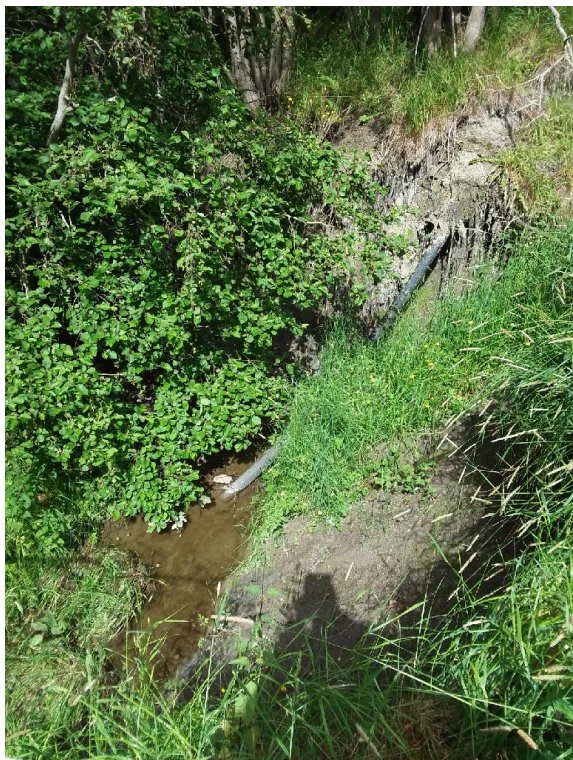
B 2 Erosjon i yttersving (noe erosjon).
