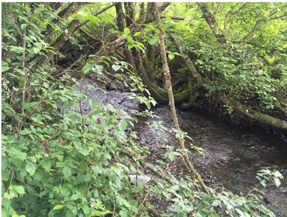
B 14 Litt erosjon i sideterreng.
