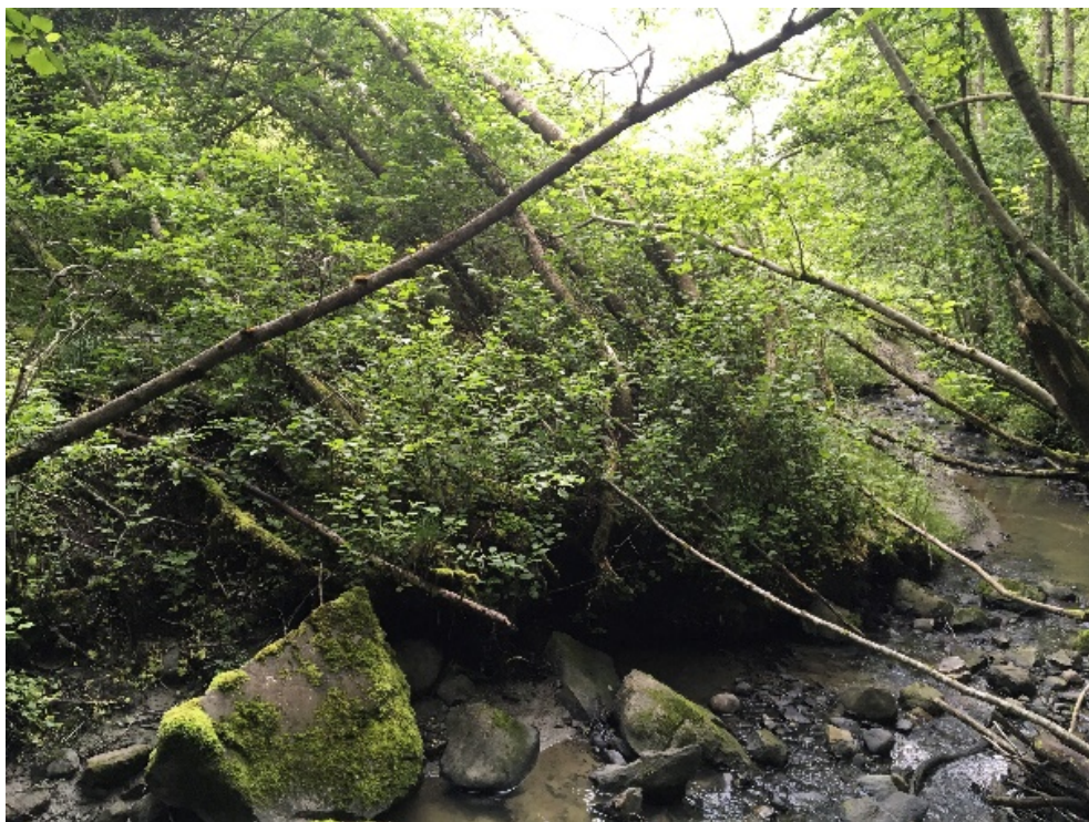
B 12 Utglidning (noe erosjon).
