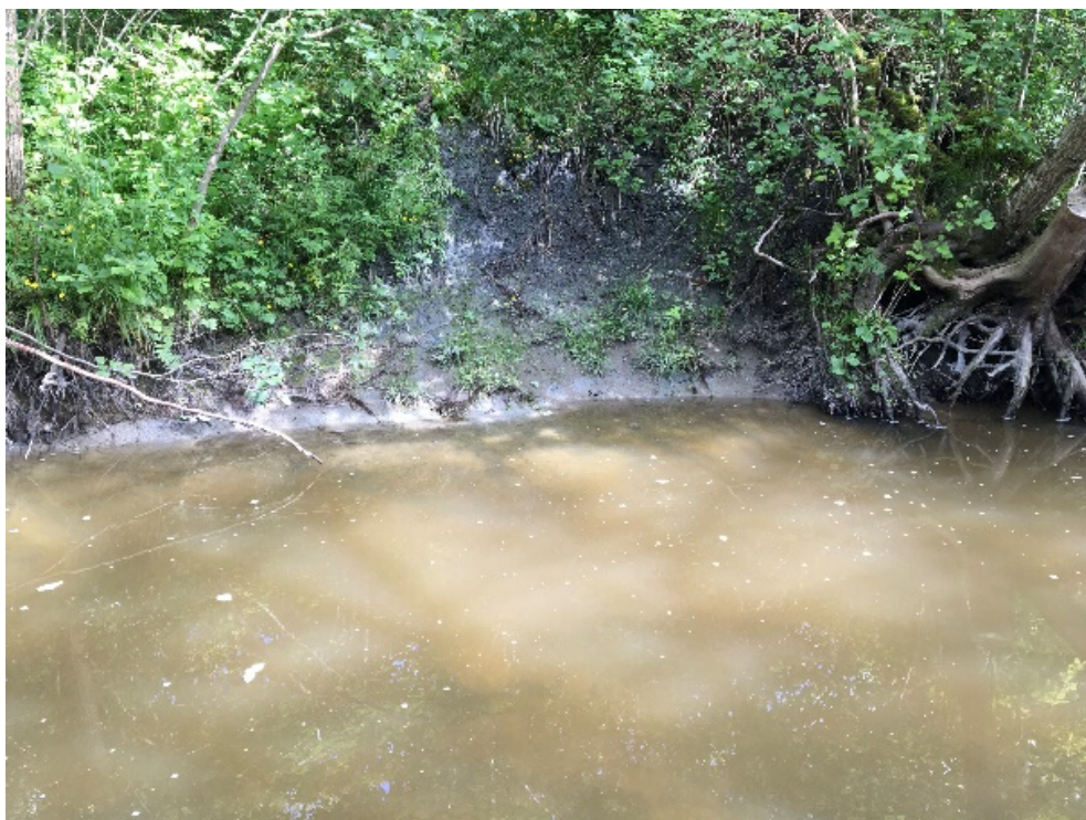
B 26 Litt erosjon i yttersving.
