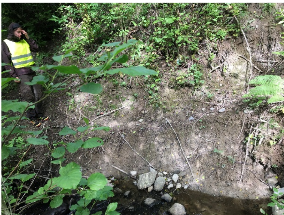
B 7 Graving i sideterreng (litt erosjon).
