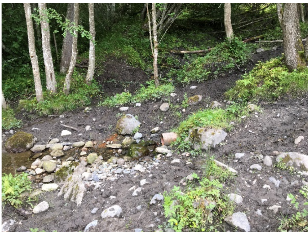
B 5 Stikkrenne, utløpet er plastret med stein. Erosjon fra krøtter.
