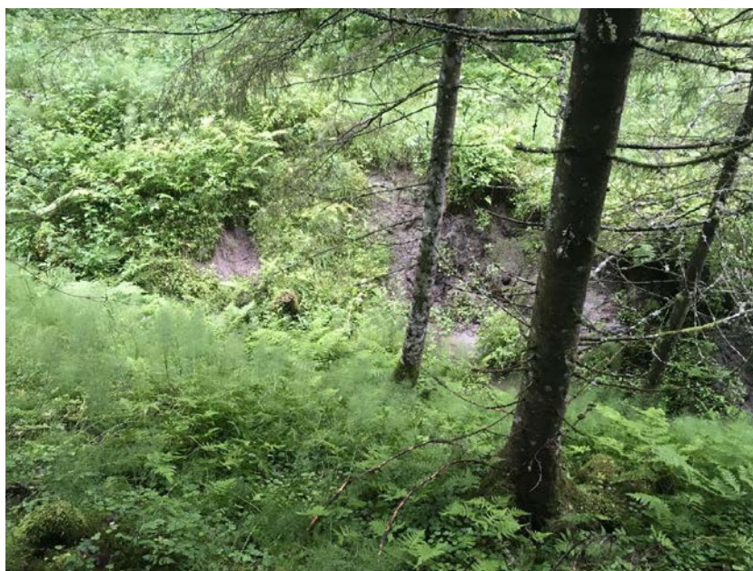
Bilde 1 Bilde mot nordøst. Noe erosjon.
