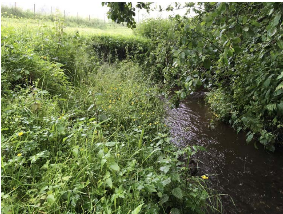
Bilde 2 Mindre erosjonssår i yttersving. Bilde mot sørøst.
