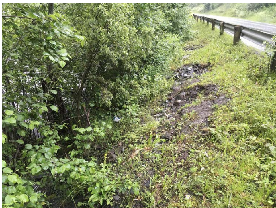
Bilde 2 Små lokale erosjonsproblemer i toppdekket i veggrøfta. Ikke observert silt/leire. Bilde mot sør.
