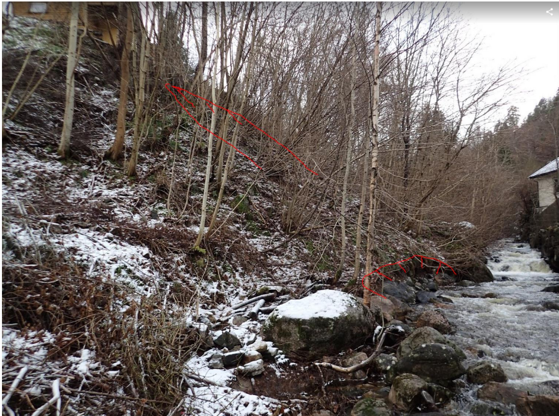
Figur 1 Skråningen nedenfor Kuliaveien 42. Noe erosjon i foten av skråningen og et grunt overflateskred i øvre del. Grove masser i skråningsfoten. Datert 28.11.2017
