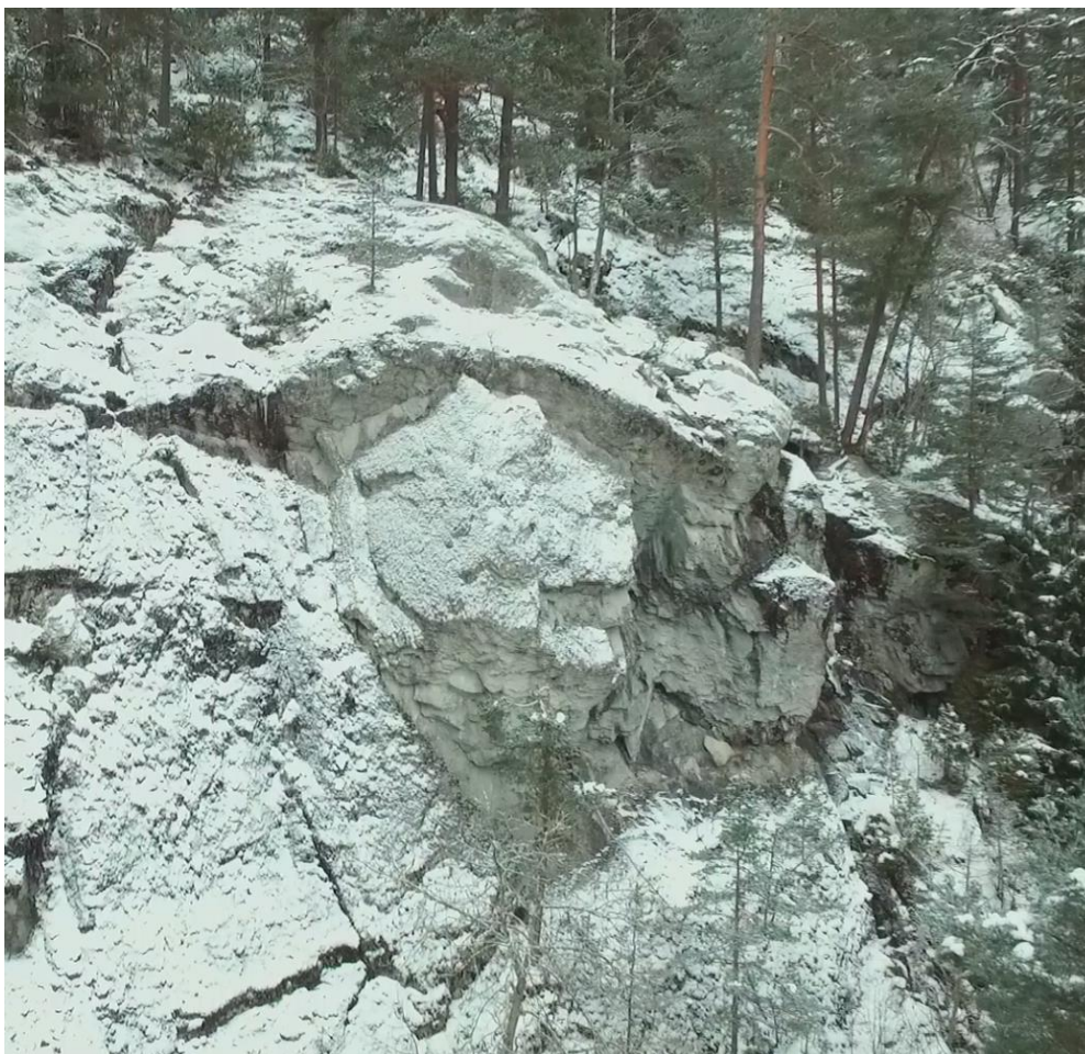
Figur 6. Deler av det oppsprukne fjellet i brattkanten over Meaksmoen. Bildet er tatt fra drone.
