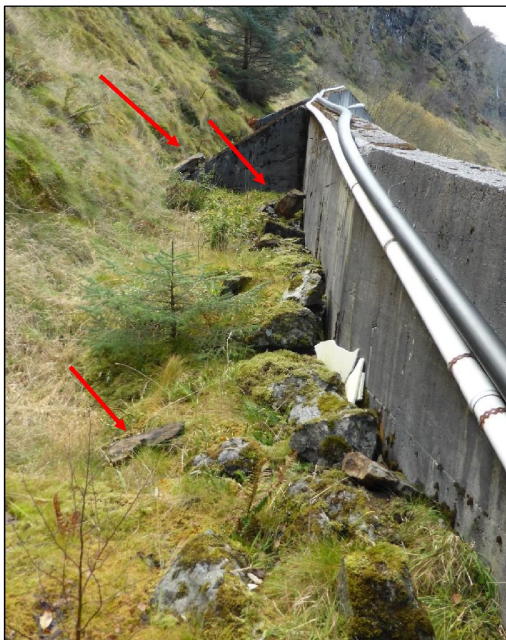
Figur 3-11 Ferske steinsprangblokker bak betongmur. Her er muren ca. 2 meter høg. De steinsprangblokkane som er med minst vegetasjon på seg, og dermed blitt vurdert til å vere yngst, er merka med raud pil. Bildet er tatt vestover frå GPS punkt 698.
