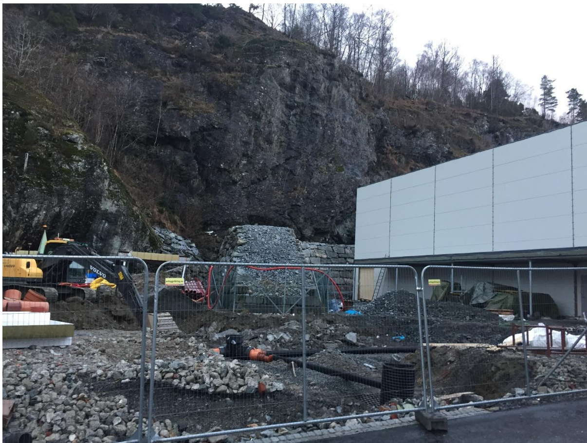
Figur 16: Bergskrent ved Eikefjord skole.
