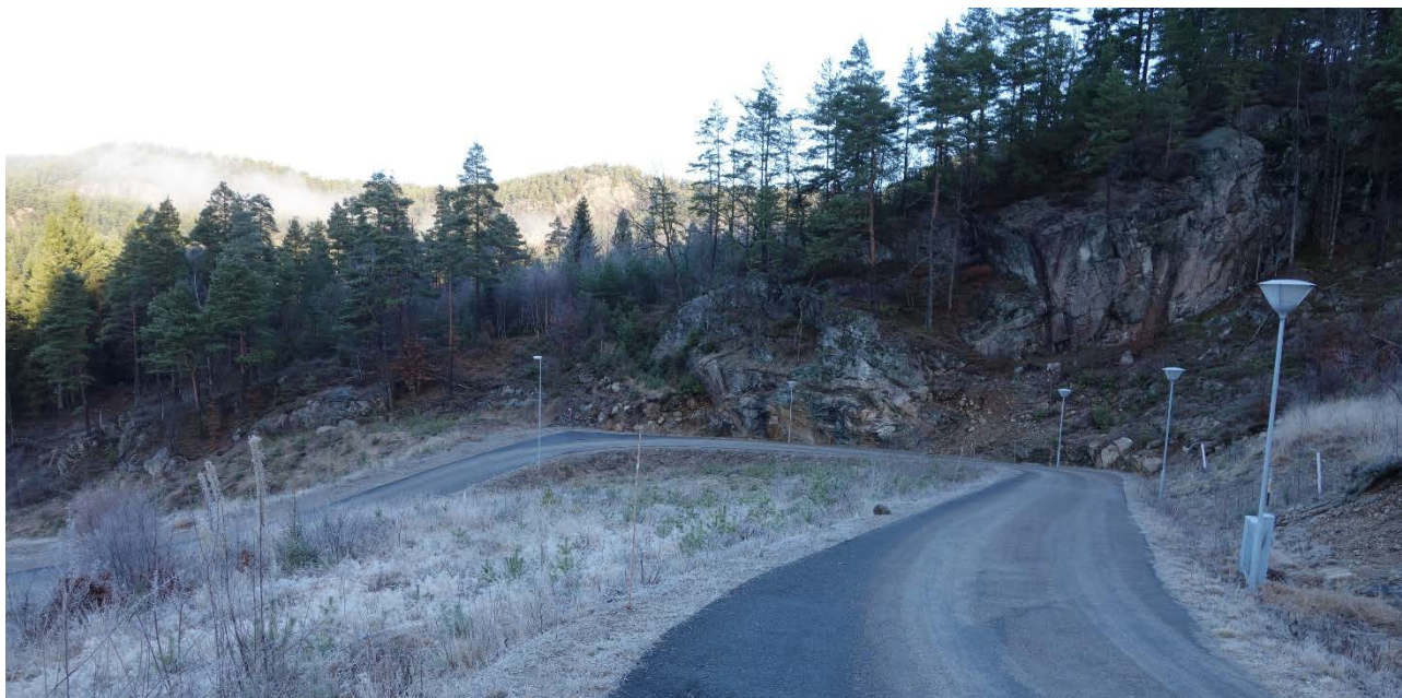
Foto 3: Nordre del med oppsprukket berg i fjellskrent.
