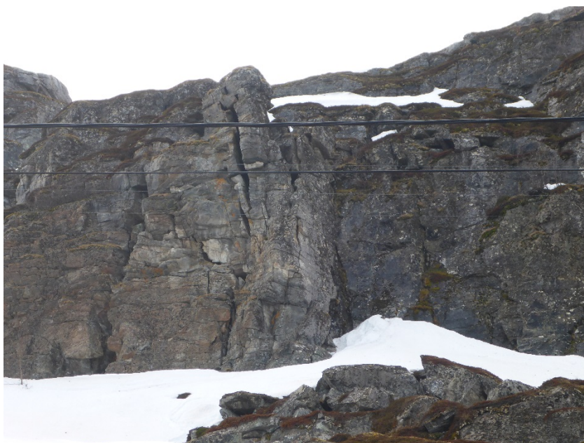
Figur 13 Eksempel på oppsprukket berg over den vestlige delen av havneområdet.
