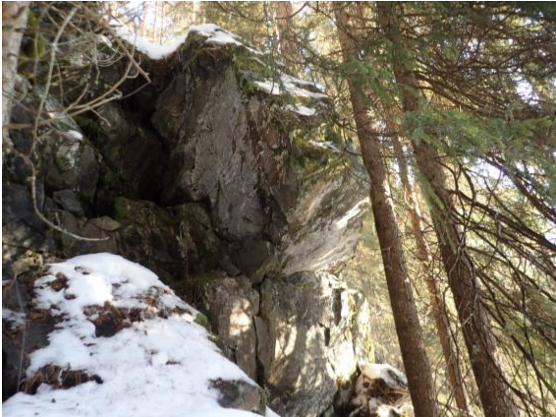
Figur 11: Avløst blokk med oppsprukket fot. Bilde er tatt ovenfor for Braskerud gård.
