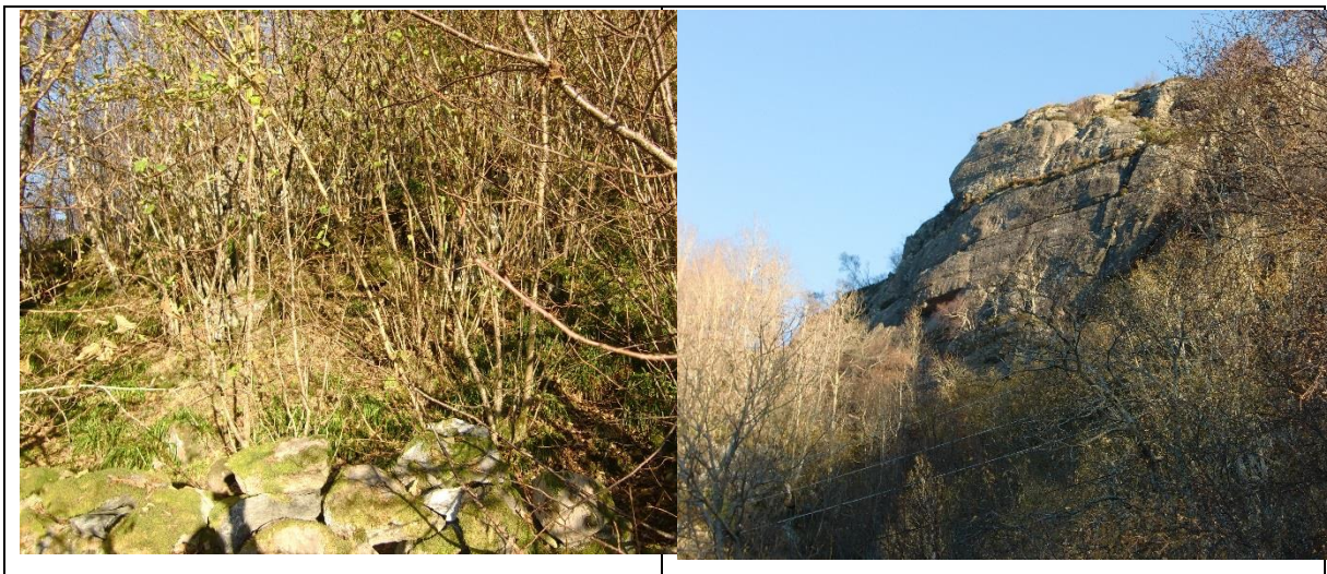
Figur 5-2: Bergskrent ved Tøvikåsen med nedfall ved foten.
