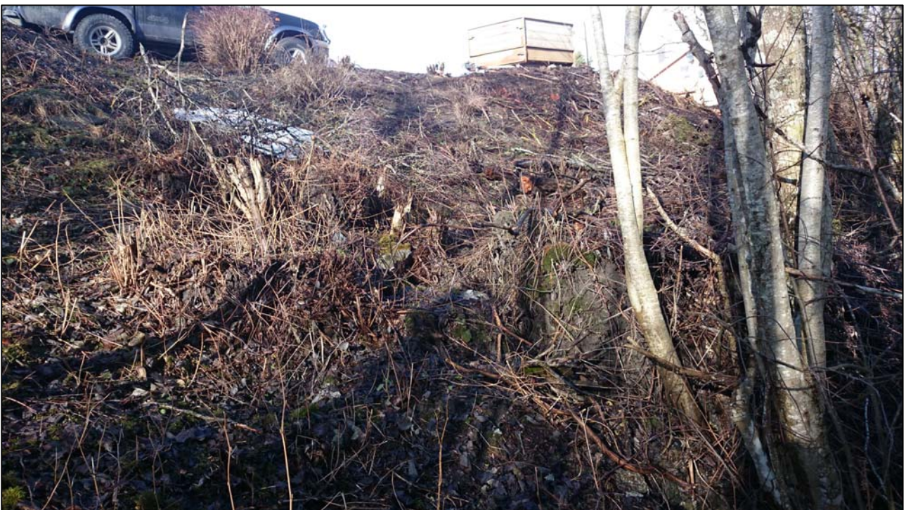
Bilde 7 – Erosjonskanal fra privat parkeringsplass til elv
