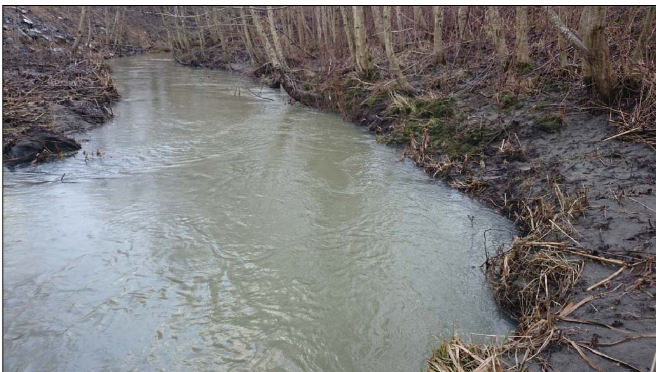
Bilde 5 – Sig i elveskråning (til høyre på bildet), se bøyde trær.
