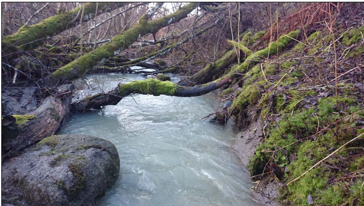
Bilde 12 – Bratt kant mot elva, erosjon i skråningsfot
