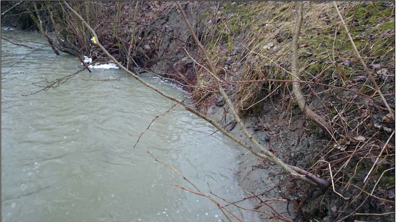
Bilde 2 - Erosjon i skråningsfot
