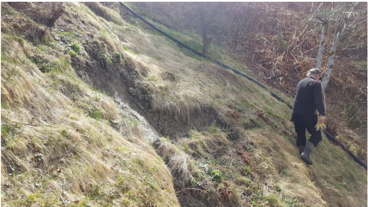
Bildet 3. Viser markert overflatglidning i øvre del av skråningen.
