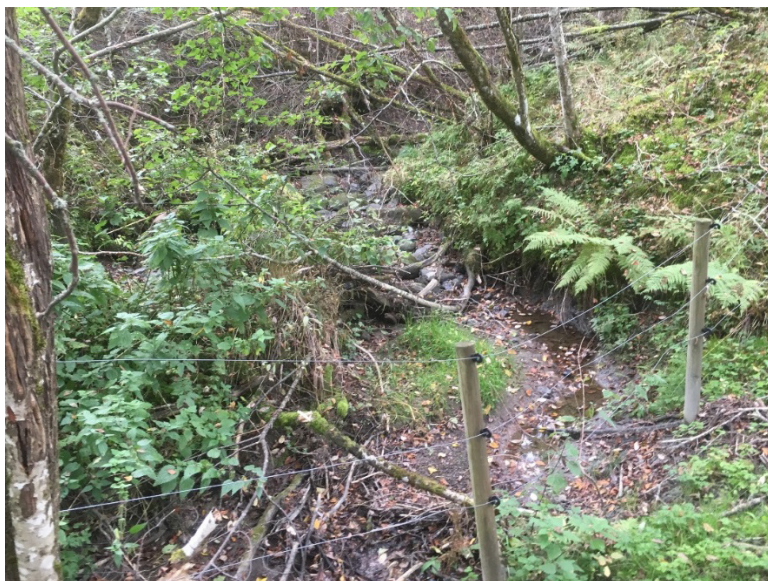
Figur H25 Lite erosjon langs bekk som gjennomskjærer sone 734 Nordli vest. Stedvis steinplastring av elvebunnen (synlig midt i bildet).
