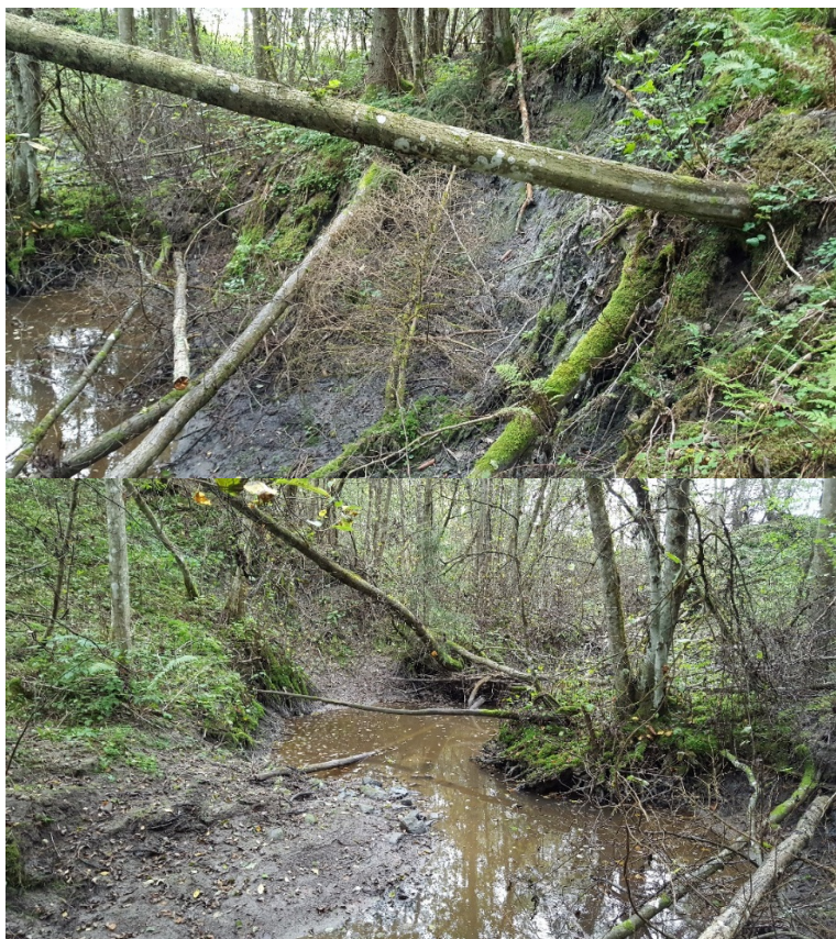
Figur H26 Overflateglidning og veltede trær langs bekken lengst sør i sone 734 Nordli vest. Øverst: sett fra sør. Nederst: sett fra nord. Foto: J. Wasrud, NVE
