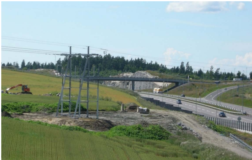
Bilde 3-1 Kabelendemast, fra 132kV Rød - Jåberg i Vestfold.
