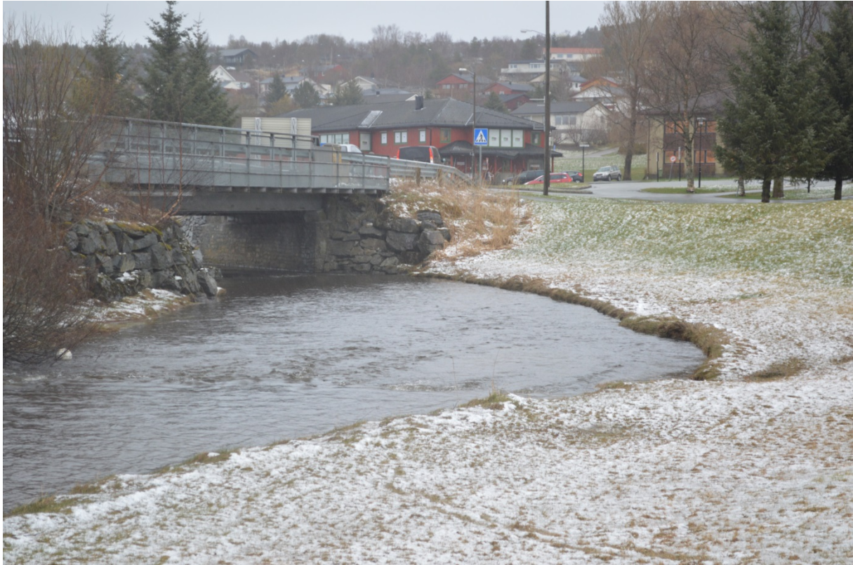
Bilde tatt fra øst mot Strandveien i vest. Det kan se ut som at vegetasjonen er noe undergravd.
