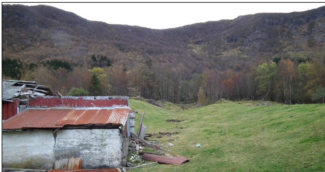
Figur 14: Den øvre delen av skråningen, samt en forfallen låve i forgrunnen. Rett til høyre for låven sees tegn på vesentlig drenering i av vann.
