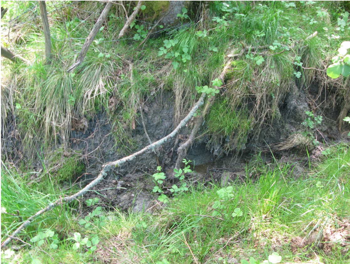
Bilde 21 Detaljbilde av lokal erosjon Gretnesbekken nord for Sarpsborgveien
