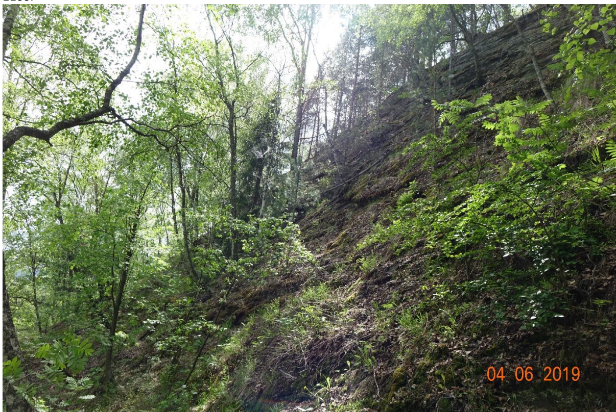
Figur 13: Bratt terrengeparti med fast fjell over veg. Rett ovanfor GPS punkt 1166.
