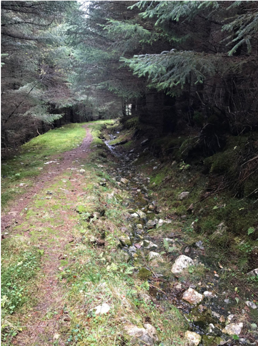
Figur 31. Mye erosjon langs skogsbilvei. Stikkrenner bør holdes ved like, eller at drens vann gis erosjonssikkert far over veien.
