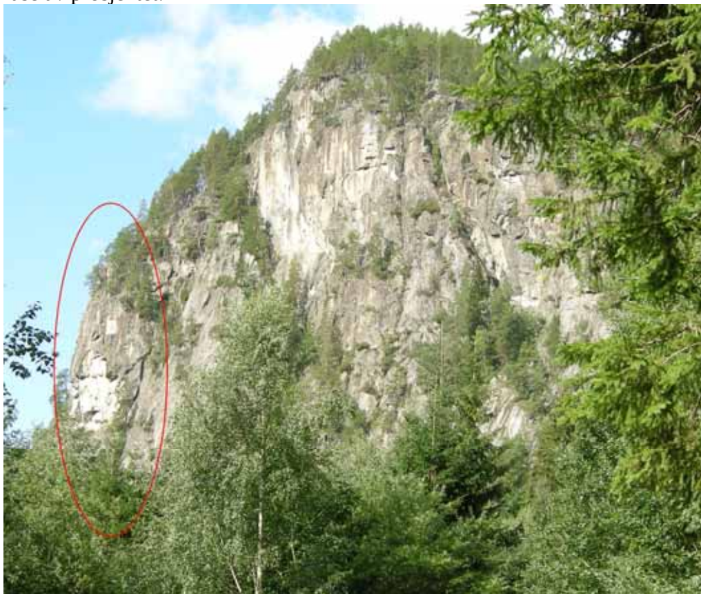
Figur 6: Ustabilt parti angitt med rødt i den sørøstvendte siden av Finnegardsnatten over Plassen. Det er også mulighet for utfall av større og mindre steinblokker fra andre deler av den oppsprukne fjellsiden.
