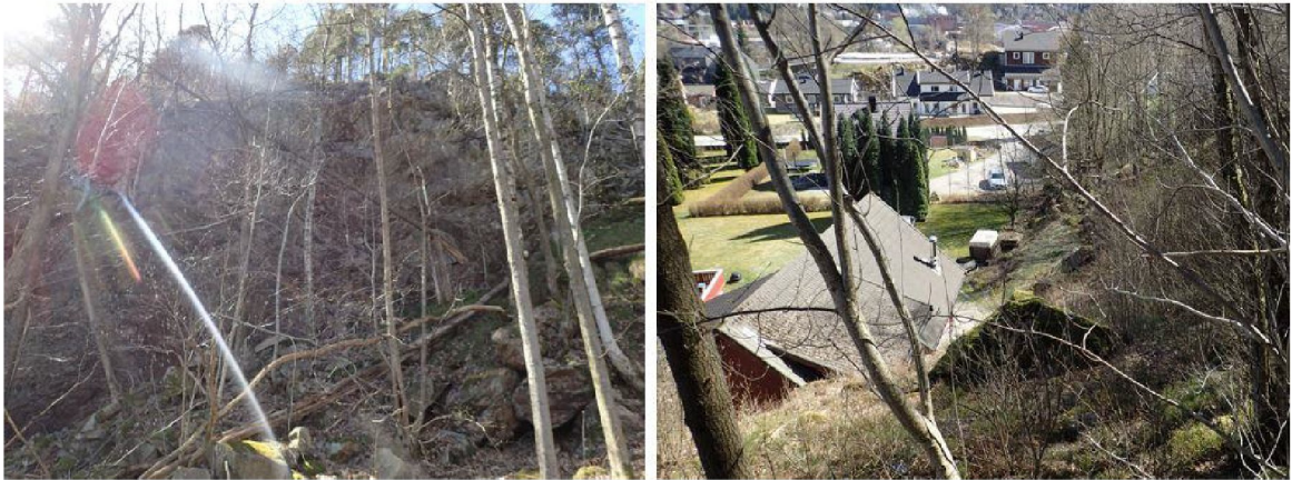
Figur 23. Venstre: Skar i sørlig del av nordligste skrent. Høyre: Blokkutløp ned mot eksisterende bygg på flaten.
