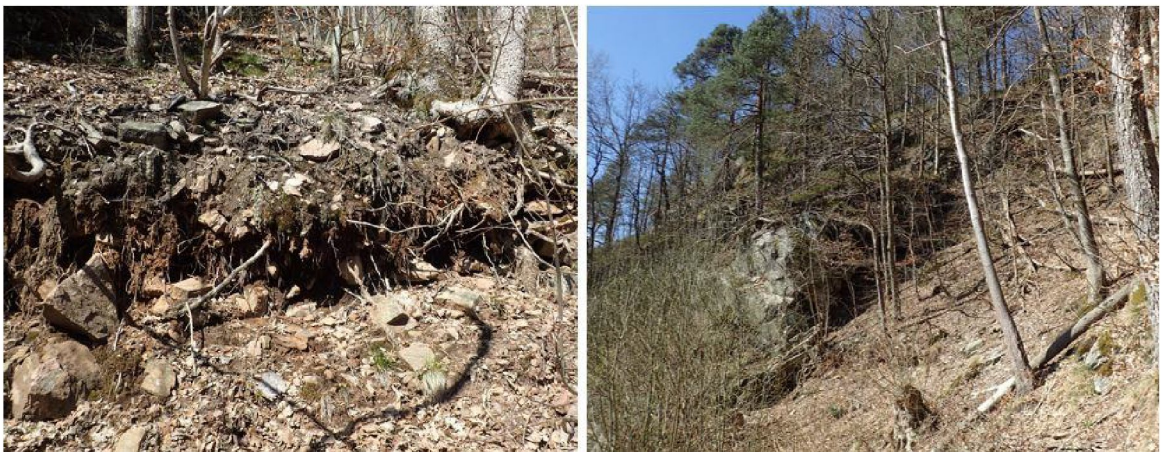
Figur 17. Omtalt renne i midtre del av området. Venstre: Løsmassene består i hovedsak av forvitningsmasser. Høyre: Nedre del av skråningen.
