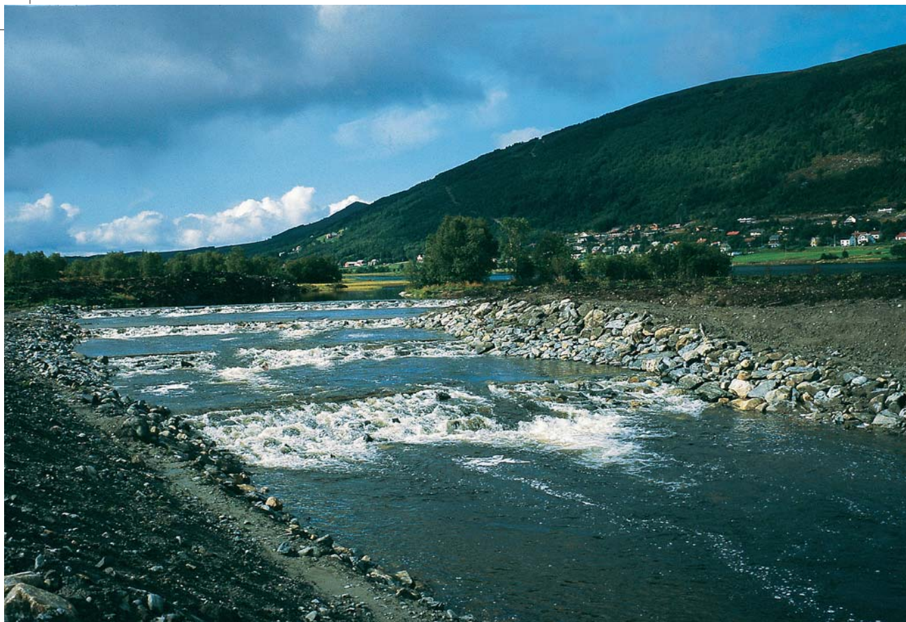
Figur 8.8 Flere terskler i serie i Hareidseelv, Hareid, Møre og Romsdal. Tersklene ligger ved utløpet av Grimstadvatnet, for å hindre senking av vatnet som har et rikt fugleliv. Det er bygd 4 terskler av stor stein med tetning av membran. Foto: NVE.
