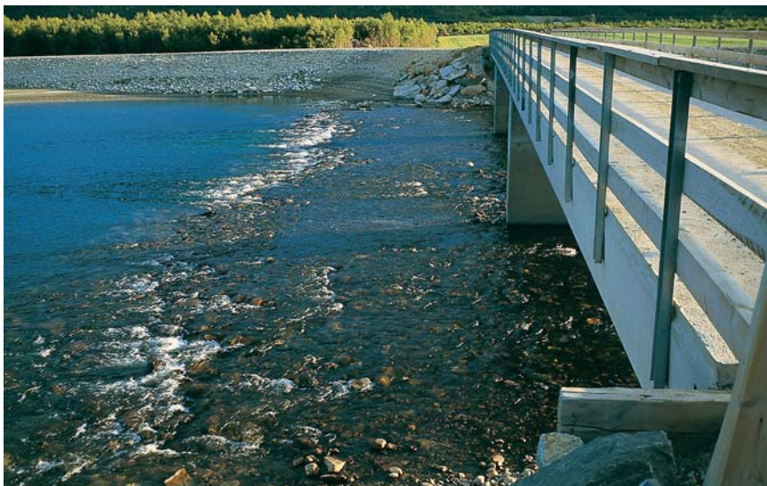
Figur 8.11 Terskel nedstrøms bru sikrer brukar mot erosjon. Lesja, Oppland. Foto: NVE.
