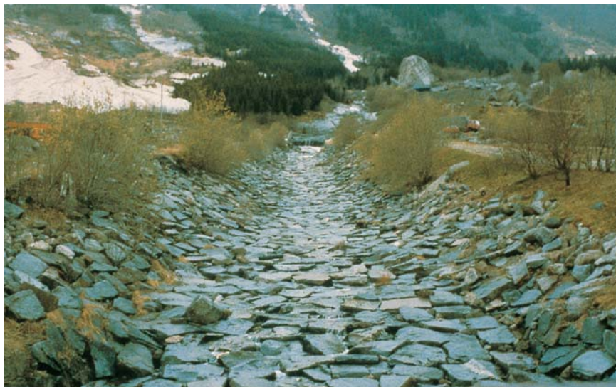
Figur 6.28 Plastring av elvebunn og sider i den bratte Tokheimselva ved Odda er mer preget av godt skjønn, utsorterte steiner av jevn og god størrelse og godt håndlag enn av ingeniørmessige beregninger. Foto NVE.
