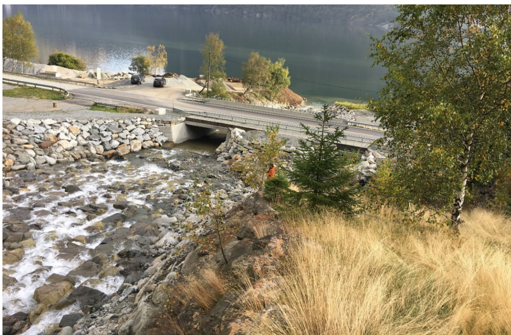
Figur 5-8. Mot veien smalner Eitrheimselva inn under veien. Dette løpet er ikke dimensjonert for å tåle flomskred langs Skredbekken og Eitrheimselva.
