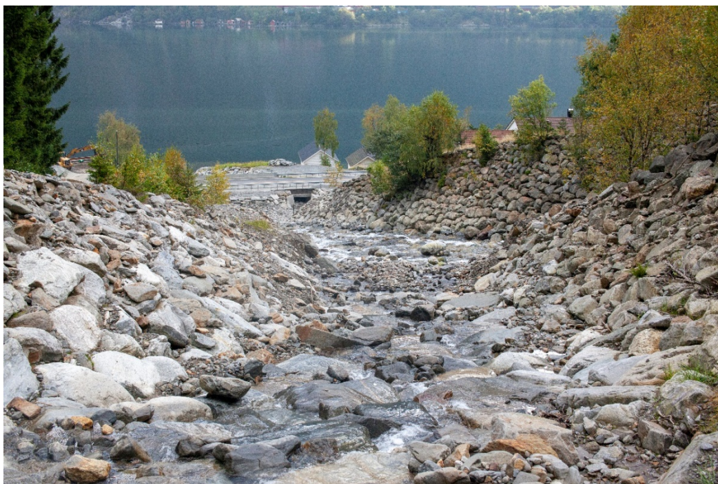
Figur 3-7. Nedre del av sikringstiltaket (mot brua) ble delvis skadet under hendelsene i 2018.
