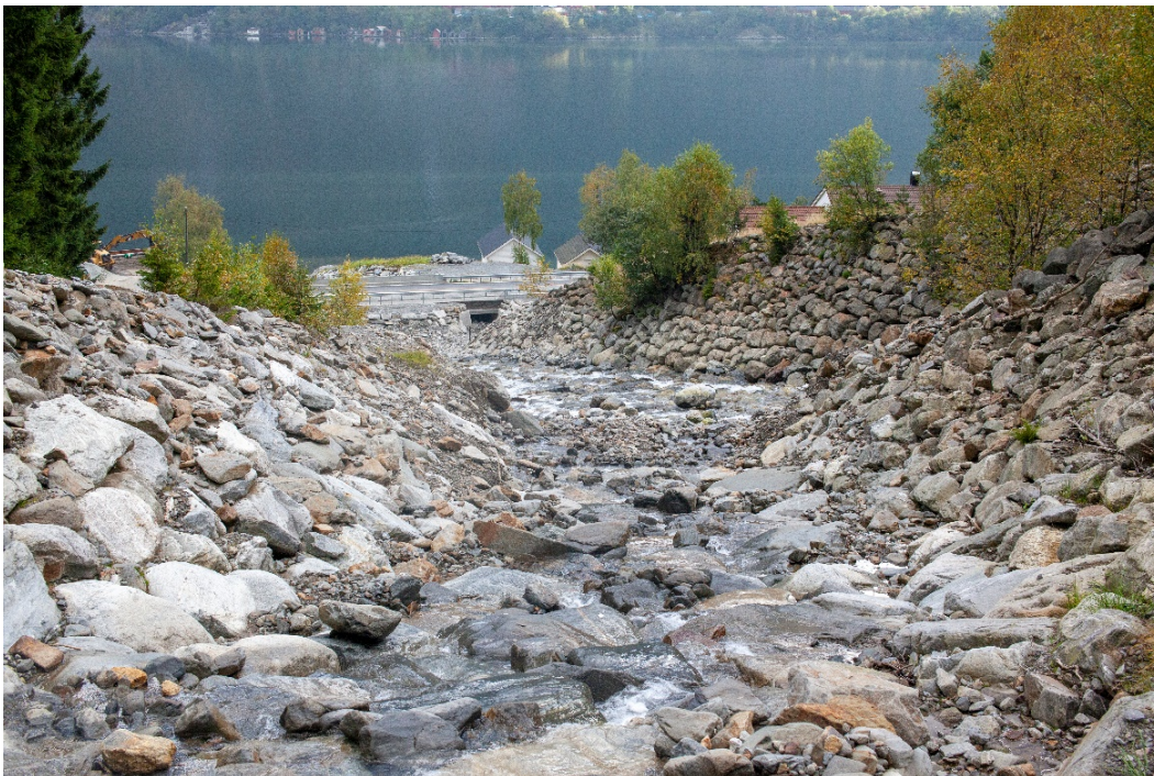
Figur 5-7. Plastring i nedre del av Skredbekken. Løpet rettes mot voll/forbygning av Eitrheimselva.
