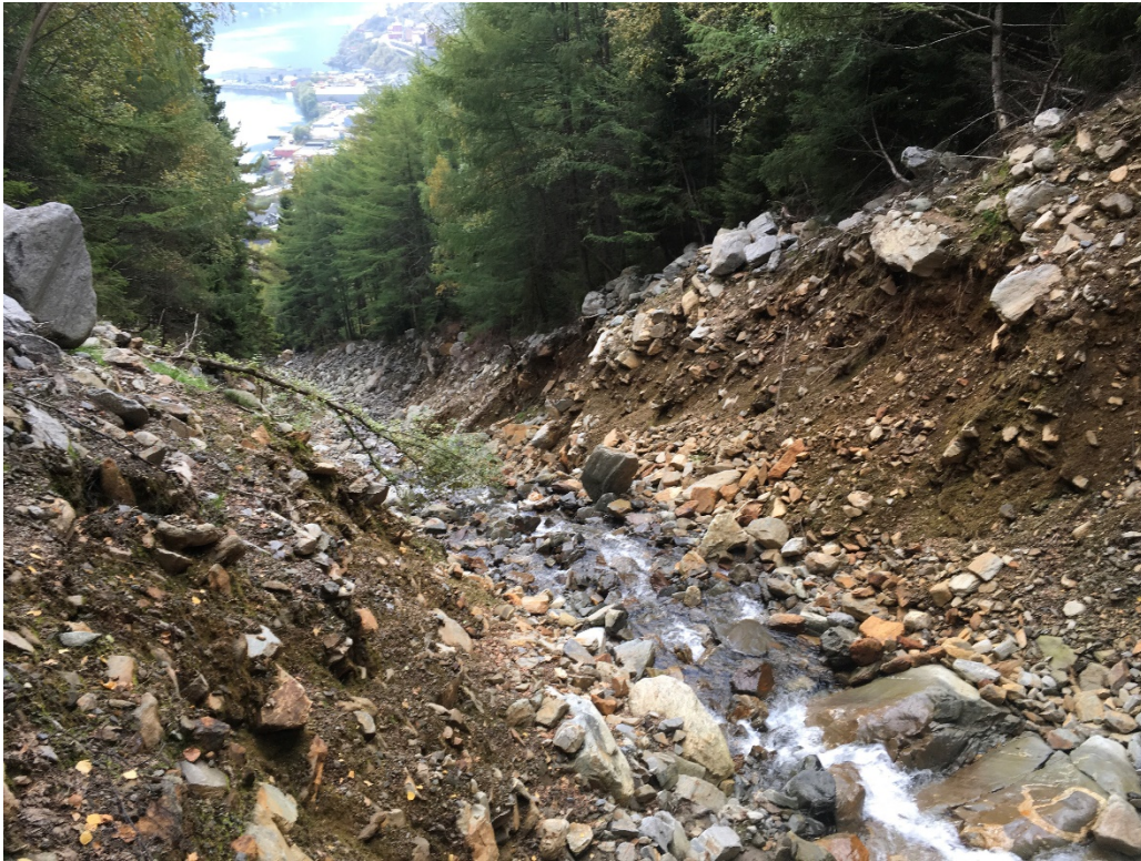
Figur 5-6. Skredbekken. Erosjon i løpet til skredbekken.
