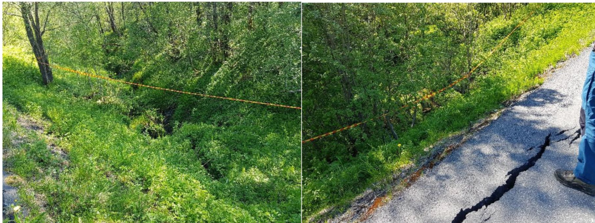
Figur 6: Bilde av en av bekkedalene der det ble registrert erosjon og sprekk i veien
