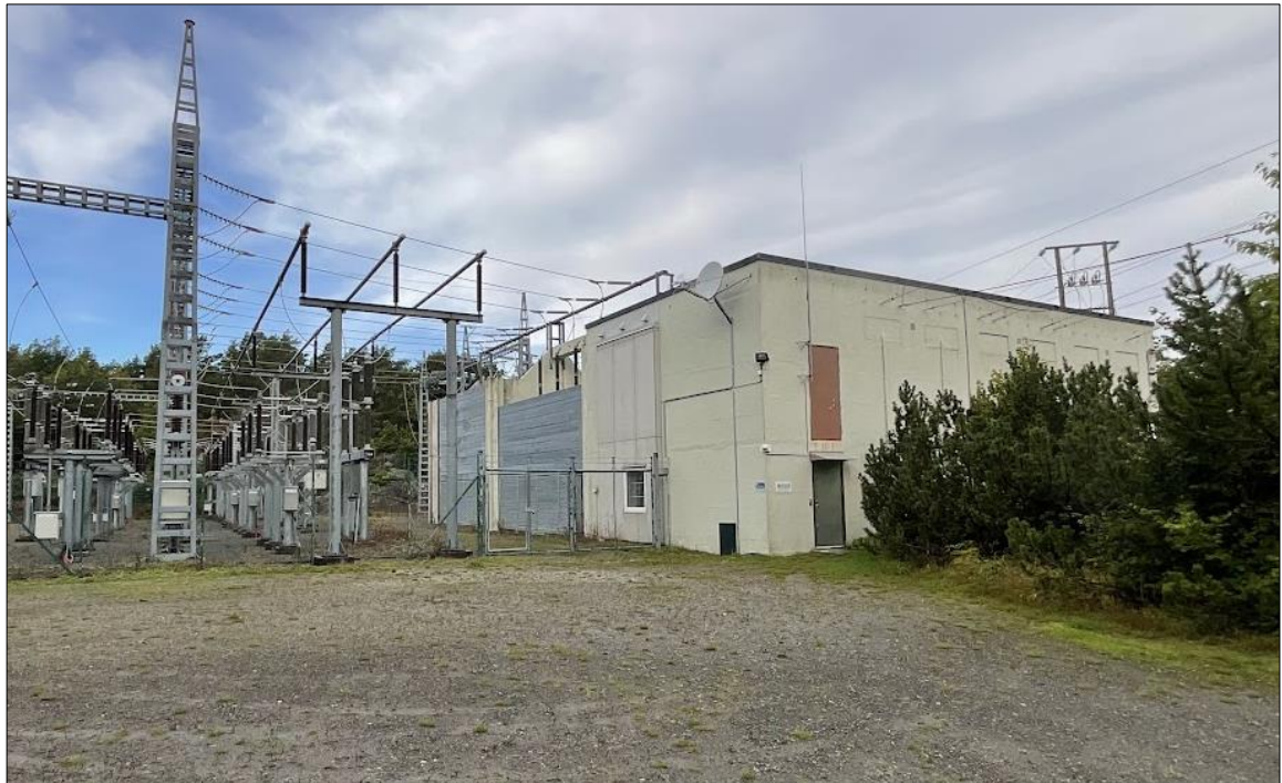
Figur 2-1 Den gamle transformatorstasjonen fra 60-tallet som skal erstattes.
