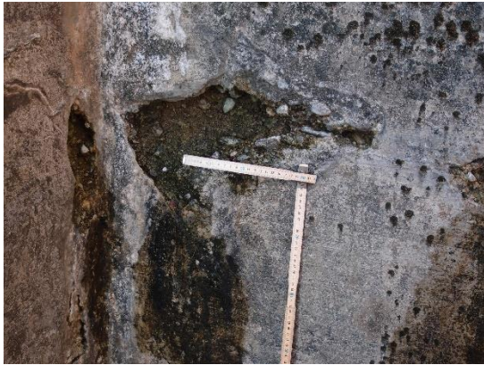
Betongen på luftsiden har relativt store skader
