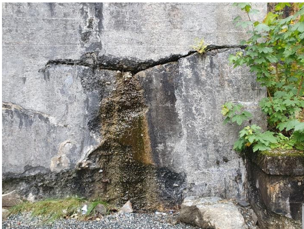
Skader i betongen på silkammeret
