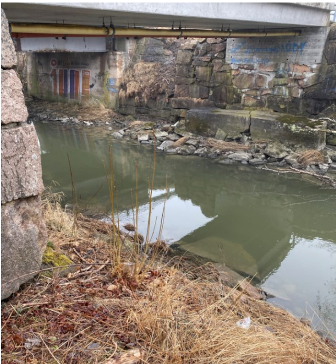
Figur 25: Foto viser fundamenter til sykkelveg og bilveg, tatt på nordsiden av brua mot øst.
