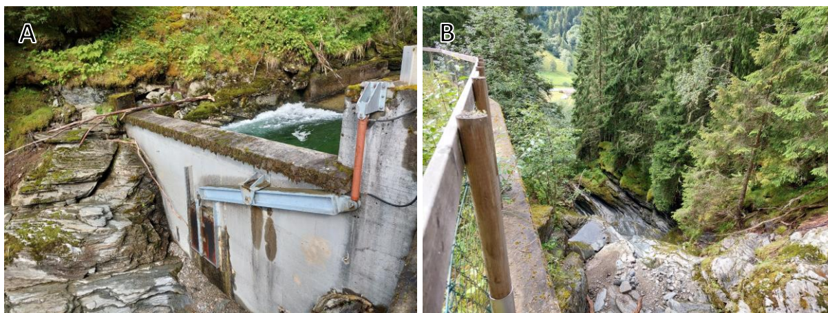
Figur 9. A) Eksisterende inntak til Hove kraftverk i Tura ved kote 375 m. B) Nedstrøms inntaket er elva helt tørrlagt.
