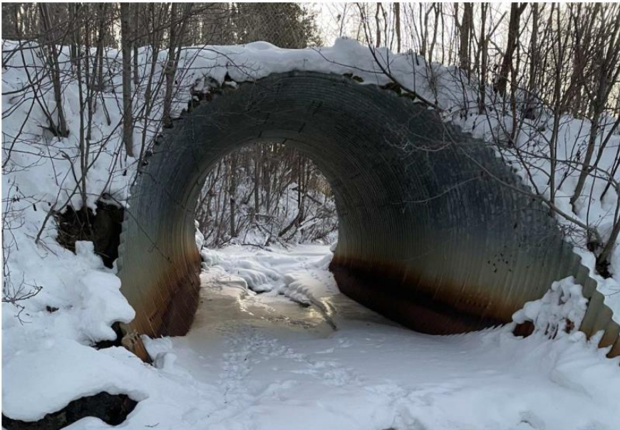
Figur 2 Kulvert nedstrøms FV 8470, som gir oppstuvning av vann i ved dambrudd på dam Stillelva. Foto: Forsvarsbygg.
