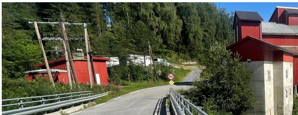
Bilde 14 Endemast for 22 kV med mastetransformator. Det er også en transformator i kiosken på bakken.
