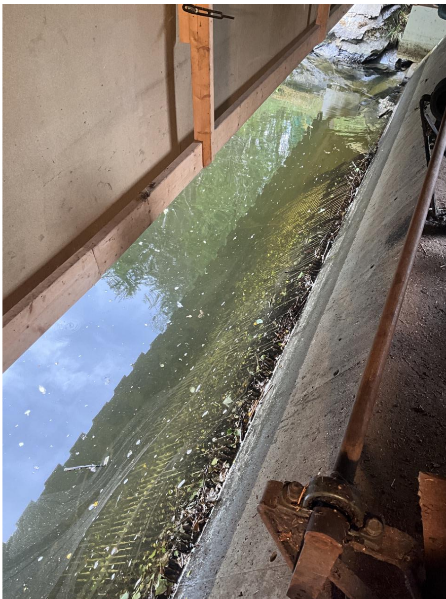
Bilde 5 Ved inntaket fra kanalen til tilløpsrøret er det finvaregrind med lysåpning 3 cm. Inntaket til det eldste kraftverksrøret bakerst i bildet har ikke varegrind.
