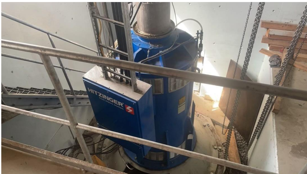
Bilde 12 Kaplan turbinen er støpt inne i gulvet i kraftstasjonen.
