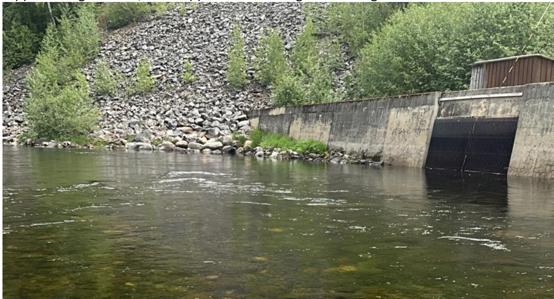
Bilde 4 Eksisterende inntak med grovwaregrind.
