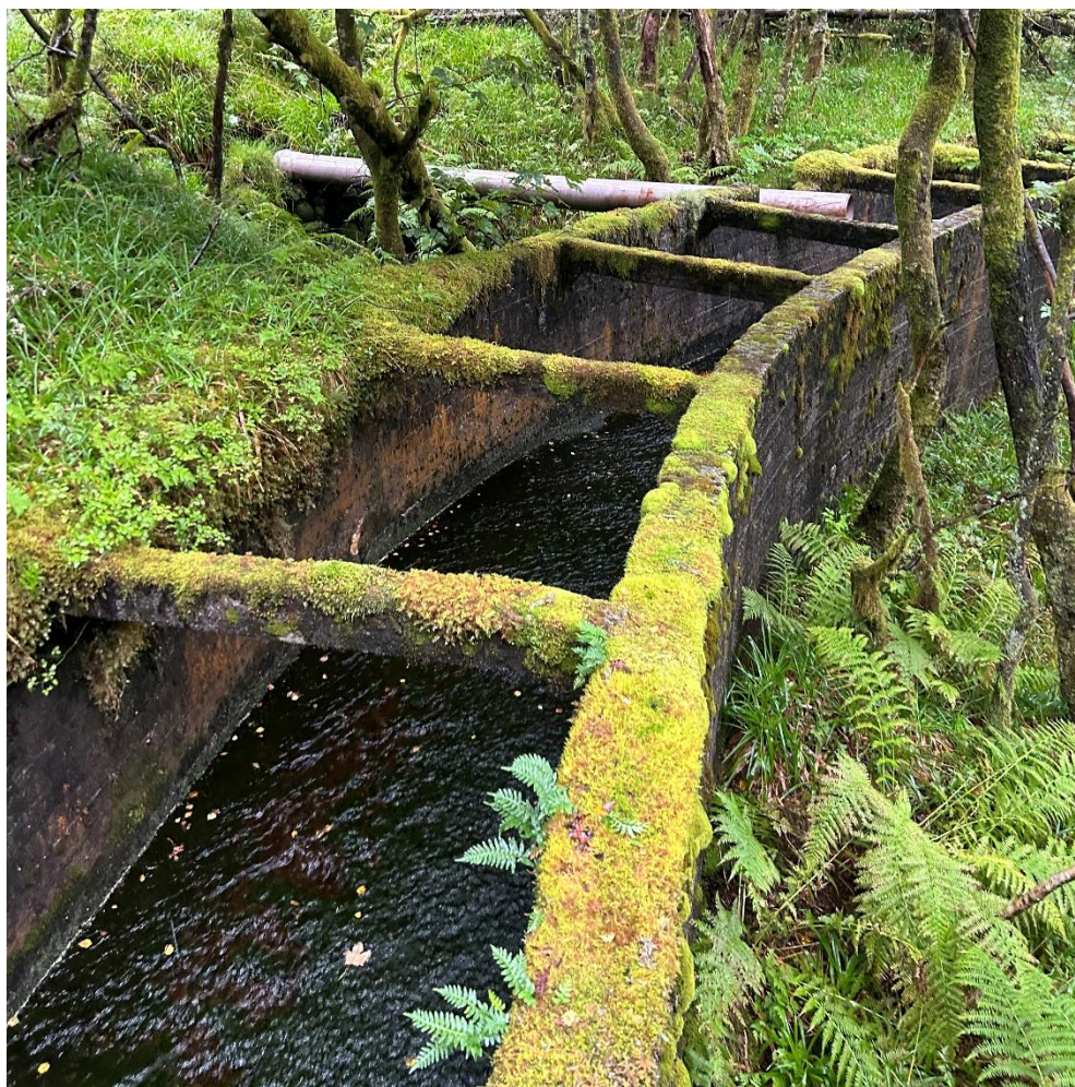
Figur 6: Omløpskanal som går rundt sørsiden av magasinet.
