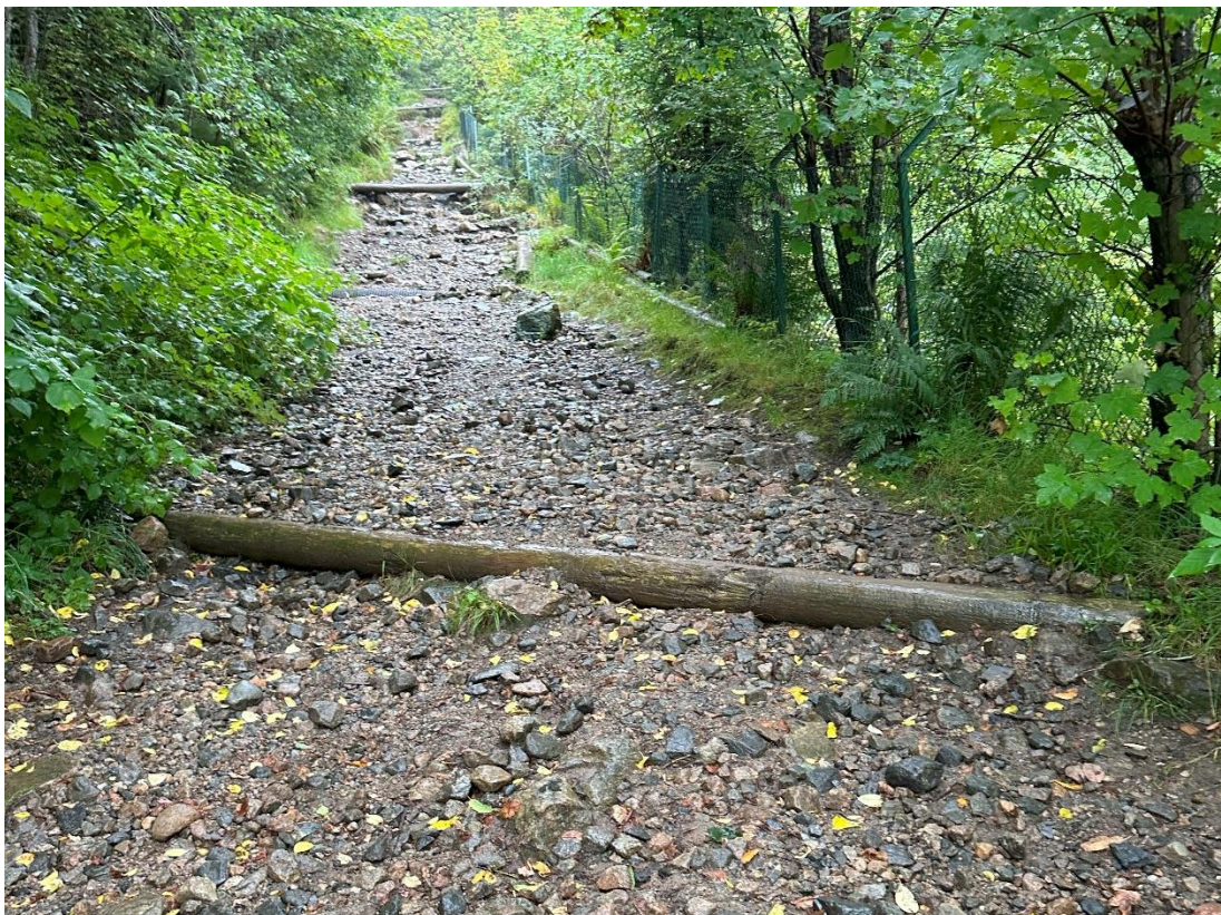
Figur 8: Deler av turstien nedenfor demningen er sterkt preget av erosjon. 'Eseltrappen' skal istandsettes som en del av prosjektet.
